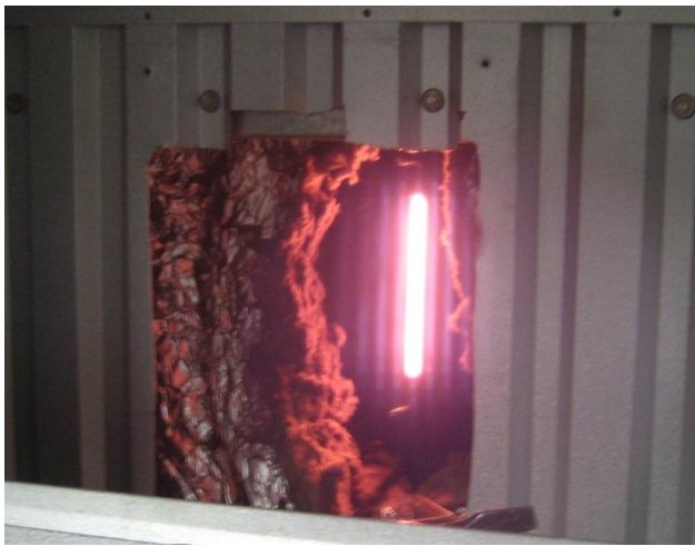
Figur 2 Hål för sonden i tubväggen i en panna (ej Uppsala)
