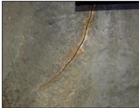
Figur 77 Spricka i väggen på en skrubber
