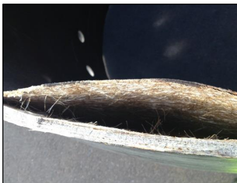
Figur 53 Delaminering p.g.a. blåsbildning i skorsten (se Figur 48)
