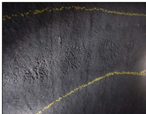
Figur 68 Närbild på erosion på en skrubbevägg
