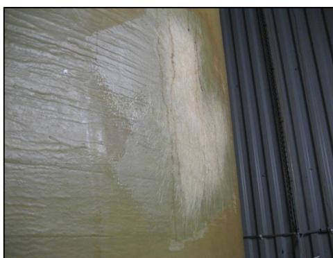
Figur 84 Ett större område med dåligt vätta fibrer på utsidan av en cistern
