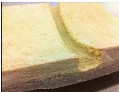
Figur 65 Korrosion i en rörskarv där roten inte fyllts
