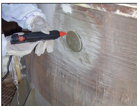
Figur 18 Hålet i manteln fylls igen med de nya rondellerna och fästs med harts
