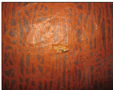
Figur 81 Uttorkningssprickor i en skubbervägg samt en slagskada
