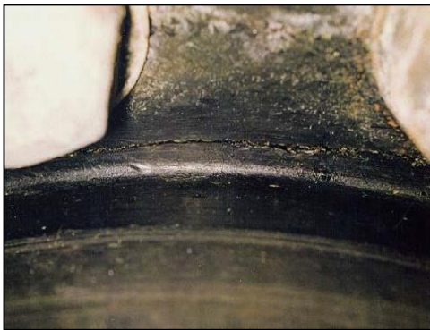
Figur 76 Spricka på en fläns. Skruvar ses till höger och vänster
