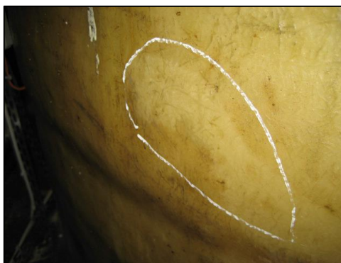
Figur 51 Delaminering på en cistern
