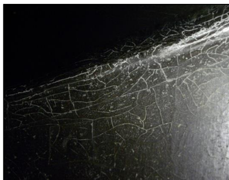
Figur 79 Exempel på ytsprickor
