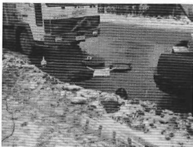
Bild 13. Optokabelns mätändar var placerade i avtappningsbrunnen.
