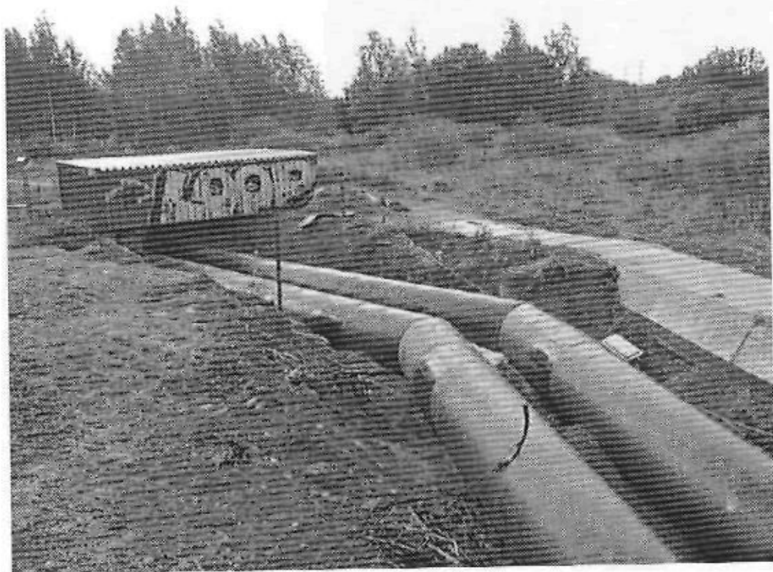
Bild 19. Slutpunkten för kabel 2 är cirka 1780 m från pumprummet.
