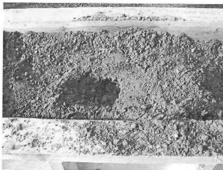
Figur 4.23 Hålrum till följd av omfördelning av kringfyllningsmaterial. Krympmuff efter 1000 cykler i 0 – 16 mm. Cavity caused by redistribution of backfill material. Double-sealed shrunk joint after 1000 cycles in 0 – 16 mm.
