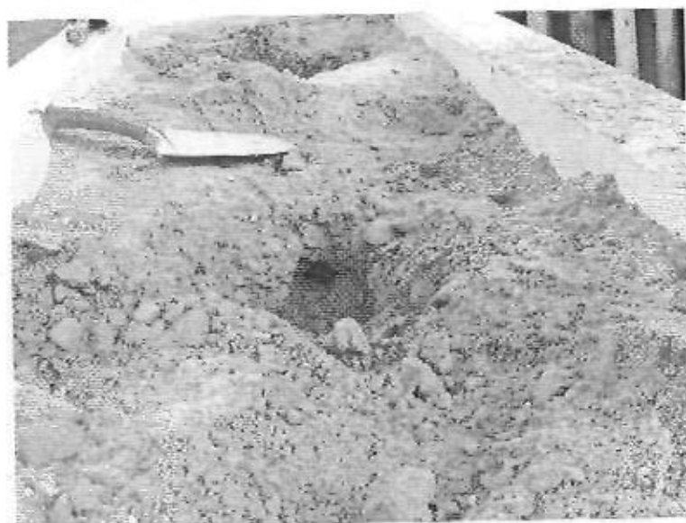
Figur 4.4 Hålrum till följd av omfördelning av kringfyllningsmaterial. Skjutmuff efter 100 cykler i 0 – 63 mm. Cavity caused by redistribution of backfill material. Sealed oversize joint after 100 cycles in 0 – 63 mm.
