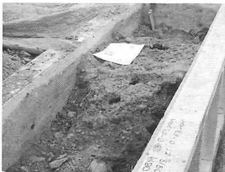
Figur 4.26 Hålrums till följd av omfördelning av kringfyllningsmaterial. Elektrosvetsmuff efter 1200 cykler i 0 – 63 mm. Cavity caused by redistribution of backfill material. Fusion welded joint after 1200 cycles in 0 – 63 mm.
