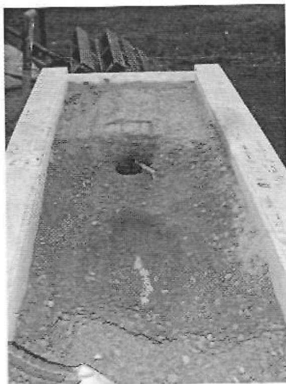
Figur 4.30 Hålrum till följd av omfördelning av kringfyllningsmaterial. Elektrosvetsmuff körd 1000 cykler i 0 – 16 mm. Cavity caused by redistribution of backfill material. Fusion welded joint after 1000 cycles in 0 – 16 mm.
