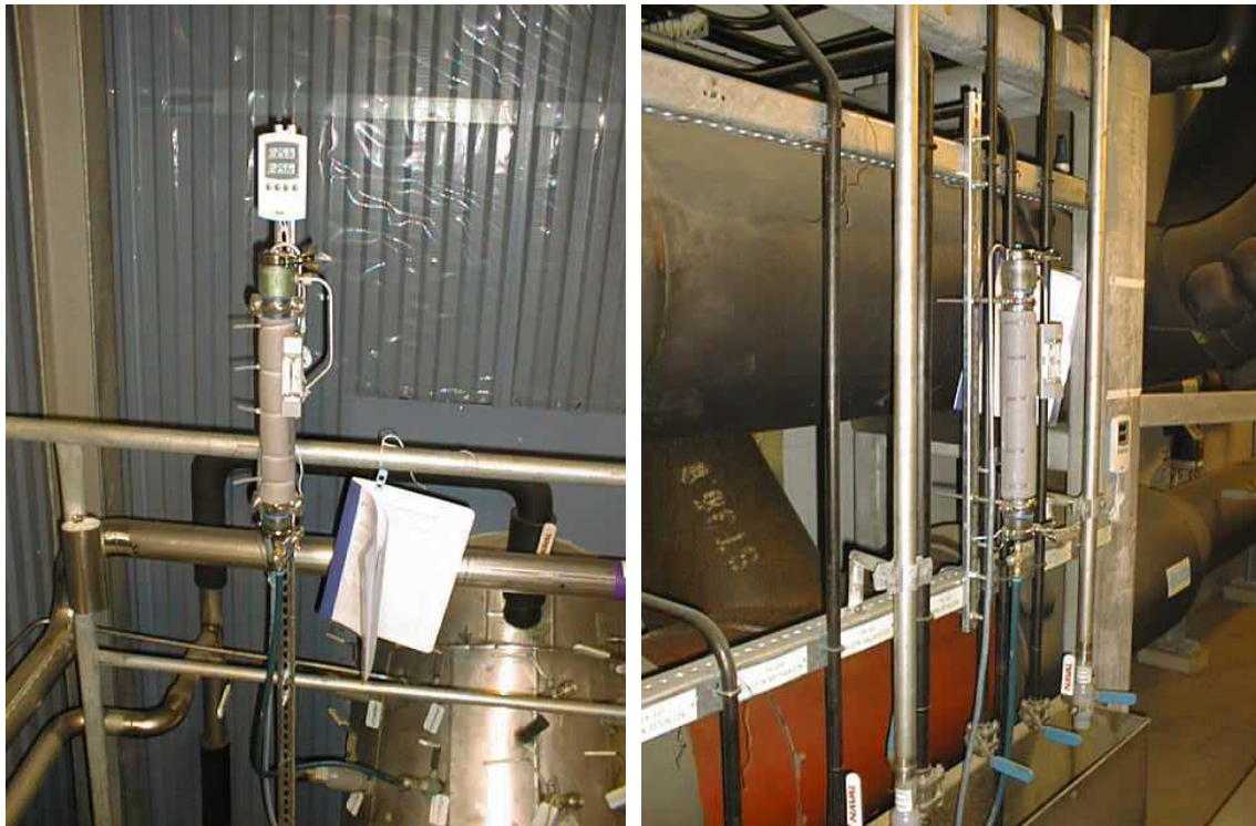
Figur 2. Exempel på anslutningsplatser för exponeringsbehållare. Bilden till vänster är från anslutningsplatsen för Värtanätet och den andra bilden från Solnanätet. Exponeringsbehållarna är omslutta av en skumplasthylsa för att skydda från eventuellt störande effekter från ljus. Vid sidan om exponeringsbehållarna finns noteringshäften för regelbundet notering av fjärrkylennätets temperatur och flöde.
