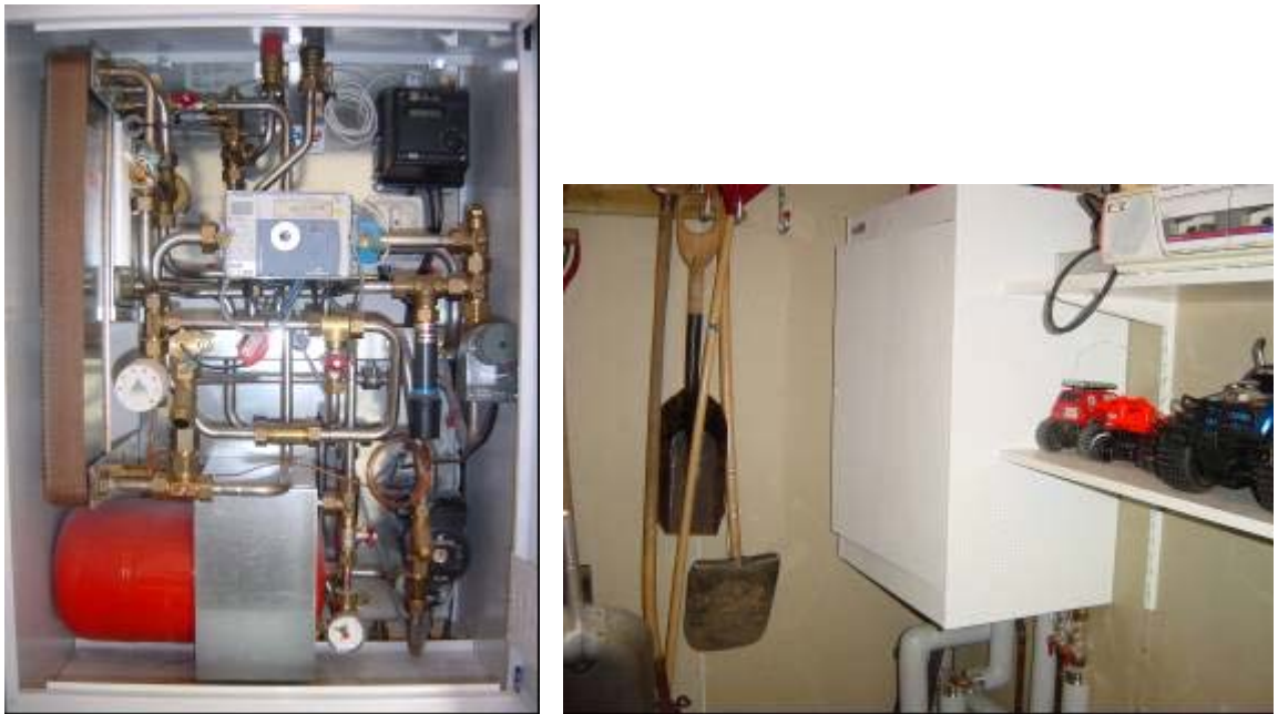
Figur 2.5: Villafjärrvärmecentraler av Typ Redan 2000 installerade i området Prästmarken. Observera de oisolerade rören inne i centralen.
