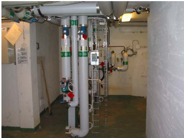
Fjärrvärmecentralen i Hus 2.
