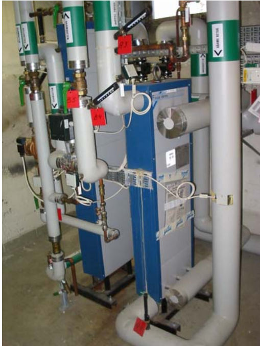
Bild 2. Fjärrvärmecentralen i Hus 1
