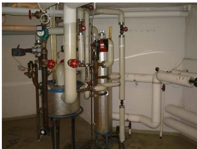
Bild 6. Fjärrvärmecentralen i Hus 3
