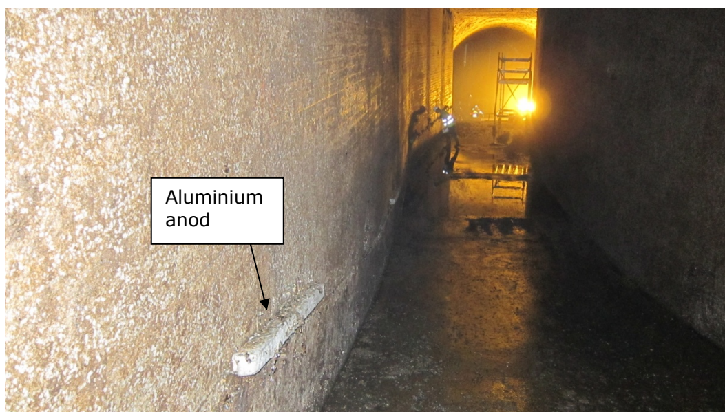
Figur 4. Den högra kanalen med offeranoder sedd ut mot inloppskulverten.
