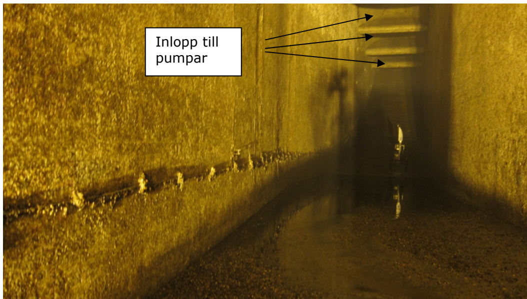
Figur 5. Den vänstra kanalen med borttagna offeranoder sedd från inloppskulverten.
