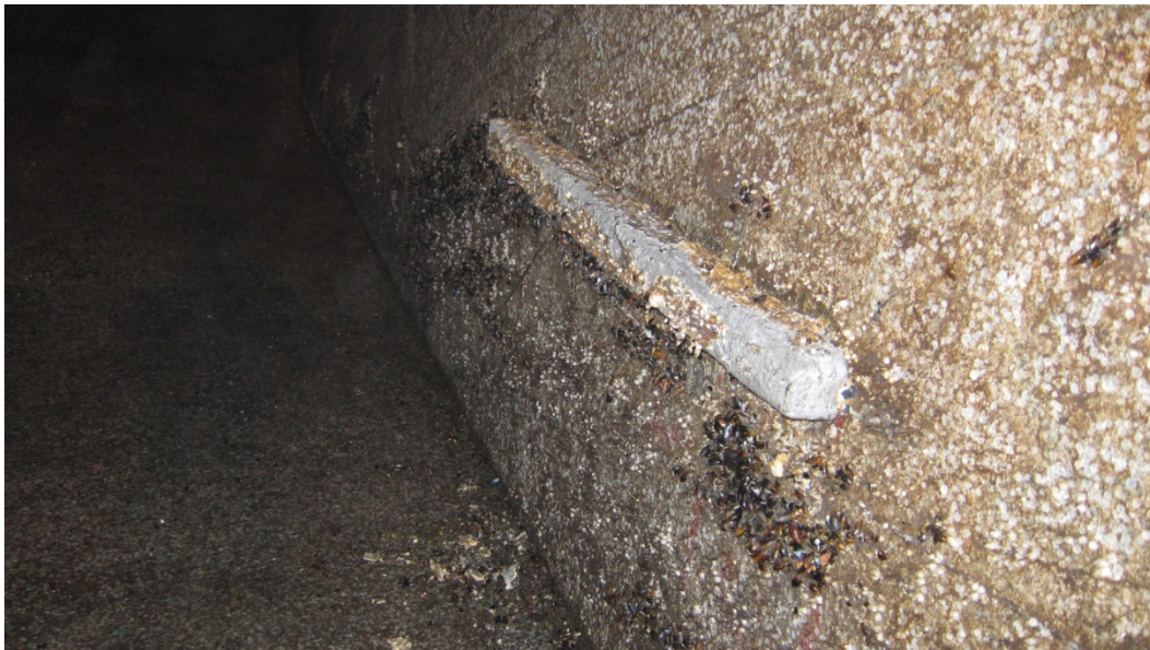
Figur 17. Anod närmast pumpar efter ett års drift.
