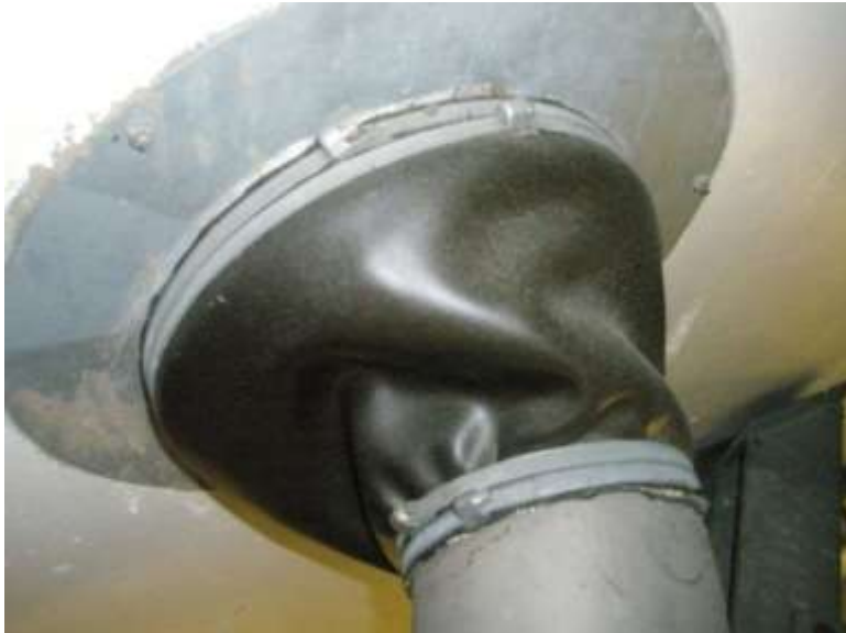
Figur 5.7. Bälgenomföring på Forsmarks kärnkraftverk, materialet är av typen EPDM.
