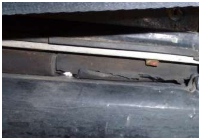
Figur 5.12 Tättningslister i R1. Tättningslisten är av typen Neopren och har brutits ner av solljus.
