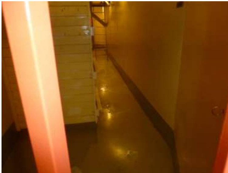
Figur 5.11. Botten av R3. Området ligger under reaktortanken och här råder det höga strålningsnivåer. Beläggningen mot bottenplanet har flagnat vilket troligen beror på fukt i betongen.
