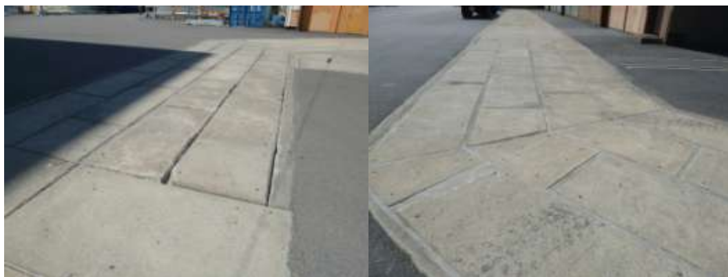
Figur 5.14 Bilden till vänster visar kulverar där fogen har försvunnit, bilden till höger visar fogmassa som nyligen applicerats.
