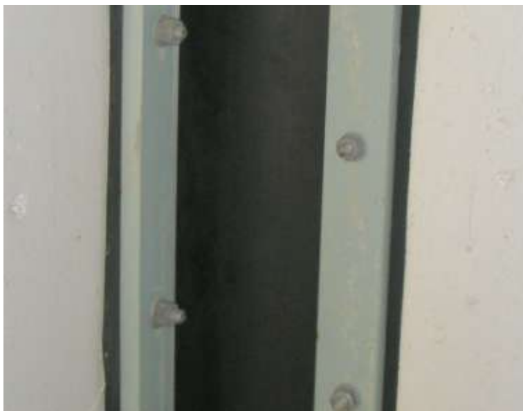
Figur 5.9. Gummiavtätning mellan reaktorbyggnaden och övriga byggnader. Den här gummiavtätningen satt i F2
