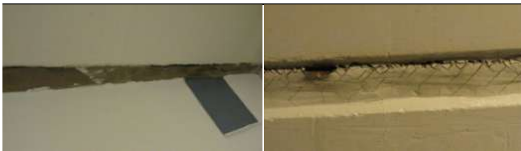
Figur 5.3. Polyuretanfogmassor. Bilden till vänster visar en omålad polyuretan fog med sprickor och bilden till höger visar en målad polyuretan fog där färgen på fogen även hade spruckit.
