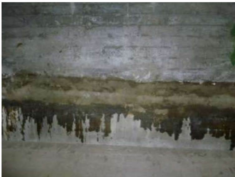
Figur 5.15 Betongvägg under R2 där vatten har läckt igenom. Troligen på grund av ett otätt fogband.
