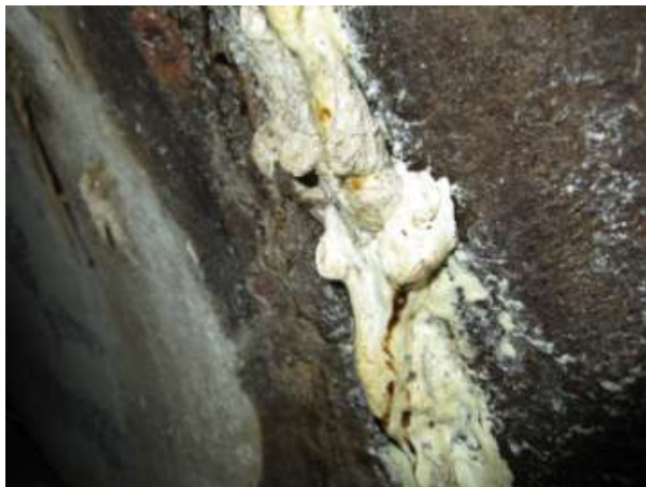
Figur 4.3. Injekteringsmassa i väggen på en dammkonstruktion i Älvkarleby i gamla stationen. Massan är av typen polyuretan.
