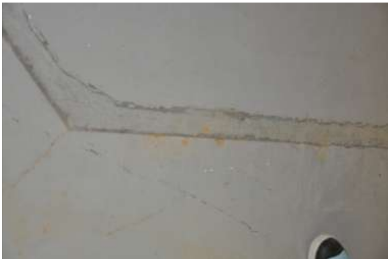
Figur 5.8. Åldrad fogmassa i Forsmarks kärnkraftverk. Den här fogmassan fanns i turbinhallen på F2.
