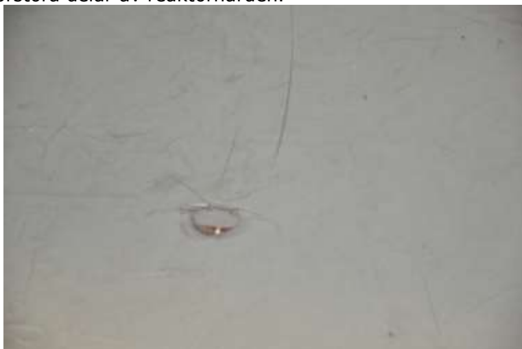
Figur 5.6. Epoxibeläggning med sprickor. Den här beläggningen är målad på betonggolvet i reaktorhallen på F2. Grundbeläggningen har aldrig ersatts men har underhållits genom att man belagt med ett toppskikt. Betonggolvet i fråga ska underhållas under november 2012.
