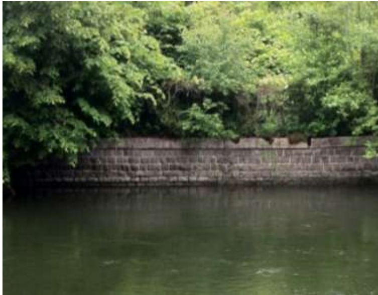
Figur 4.6. Dammvägarna vid Olidans vattenkraftverk är av typen stendamm. Fogbruket mellan stenarna längs vattenlinjen slits och måste kontinuerligt underhållas. Man vill undersöka om en polymerbaserad lösning kan finnas.
