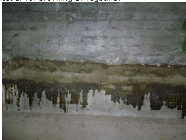
Figur 3. Betongkonstruktion där vatten har runnit igenom gjutfogen mellan två betongblock. Missfärgningen är antagligen ett resultat av att nedbrytningsprodukter från fogbandet lakats ur, och transporterats med vatten och bildad avfällningar på betongytan. Bilden är tagen på Ringhals kärnkraftverk under Ringhals 2.
