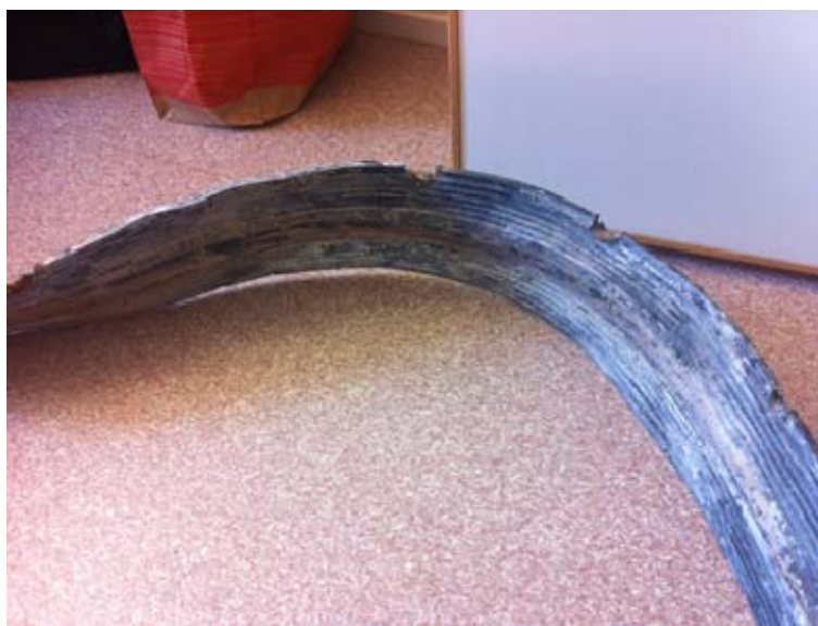
Figur 5. Fogbandet som suttit i en av vattenvägarna i Ringhals kärnkraftverk
