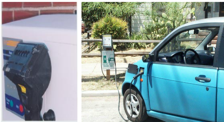
Figur 3.1 Exempel på anslutningsdon för konduktiv laddning med beröringsskydd (i bakgrunden syns delar av laddningsstationen).
