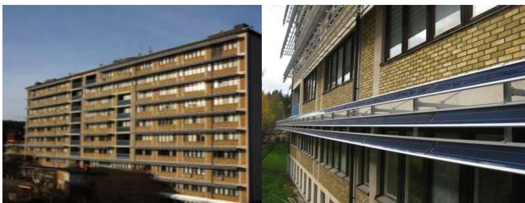
Figur 8. Solavskärmning med solceller på Sollefteå sjukhus
