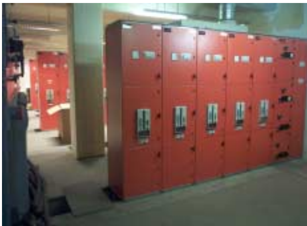
Figur 6a. Ställverk levererat av Ahlstrom
