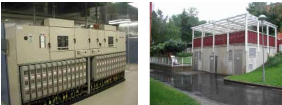
Figur 10. Interiör och exteriör av ombyggd 2x1000 kVA nätstation.
