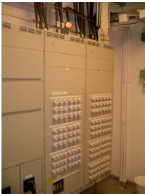
Figur 17. Foto på en elcentral som matar en lunchrestaurang. Överst syns utgående kablar till restaurangen.
