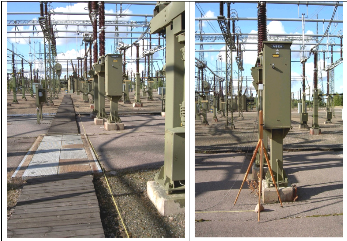
Figur 67. 220 kV. Bilden till vänster visar en mätlinje längs ett fack med stativ till frånskiljare i förgrunden och stativ till brytare längre bak. Bilden till höger visar mätproben uppställd invid ett skåp på ett brytarstativ.
