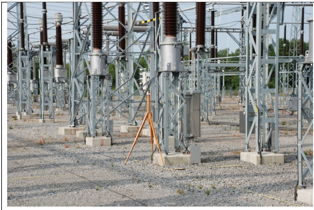
Figur 63. Mätprob och stativ uppställd framför ett apparatstativ.
