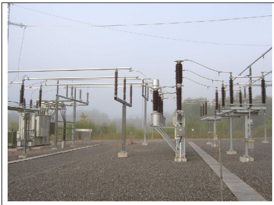
Figur 36. 130 kV. Samlingsskena till höger, ett ledningsfack i förgrunden och ett transformatorfack i bakgrunden.
