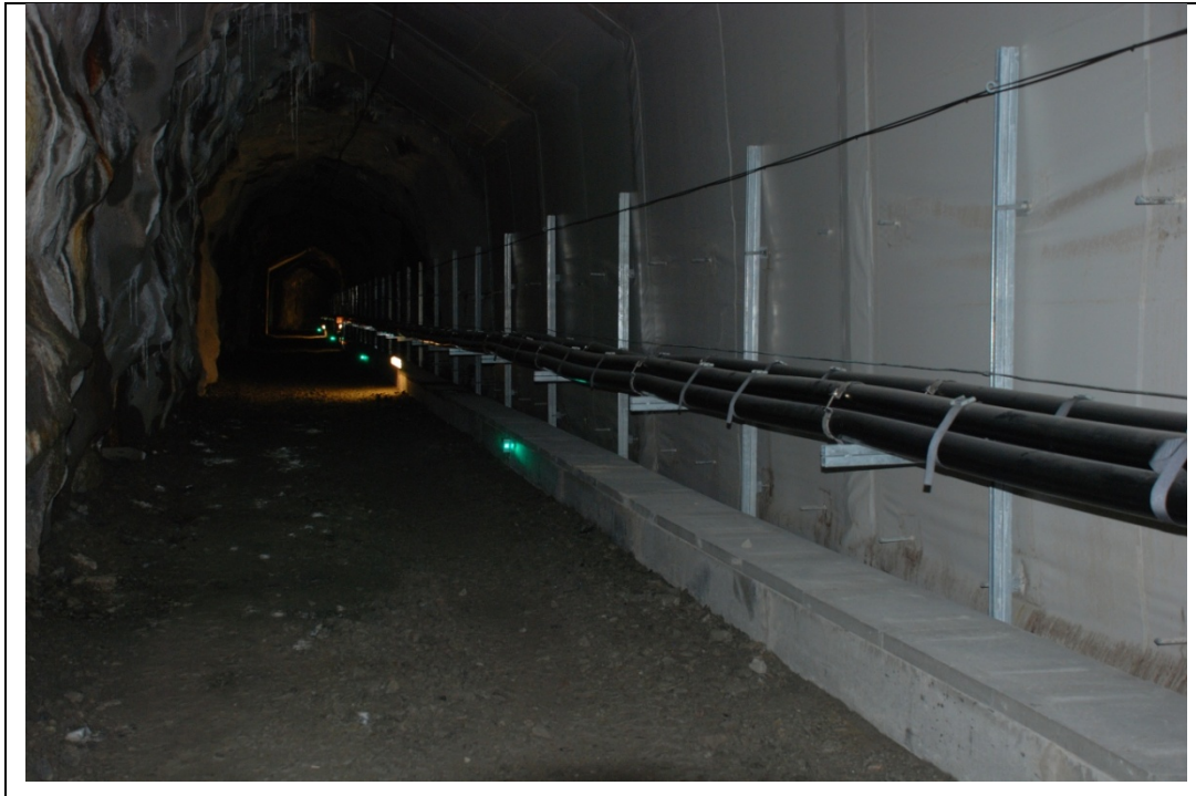
Figur 46. Avsnitt av tunneln med kabelförband.
