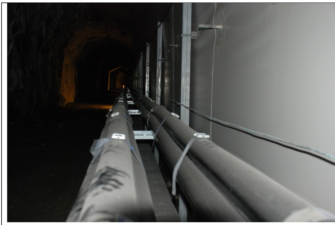
Figur 47. De två parallella kabelförbanden. Notera linan till höger som jordar ankarskenor och konsoler.
