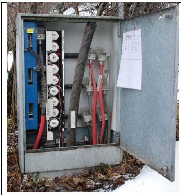
Figur 39. Ett äldre kabelskåp från ELGE.
