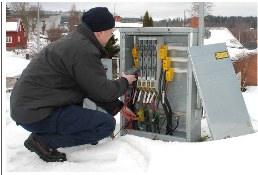
Figur 38. Arbete i ett tämligen nytt kabelskåp från Kabeldon.
