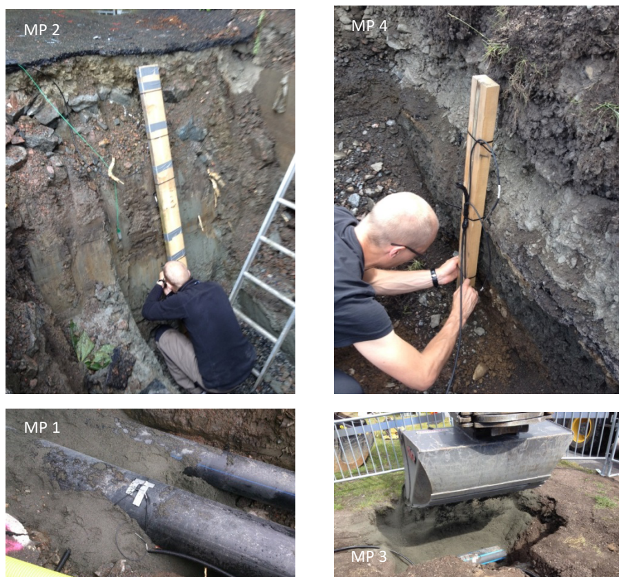
Figur 3: Installation vid mätplatsen i Almedal av MP1-4. Kablar till givare ligger i stenmjöl 0-8 mm nära givarna och för övrigt i rör till elskåp. Vid MP2 & 4 är temperaturgivare intryckta i befintlig schaktvägg. Vid MP2 sitter de tre översta givarna i befintligt grus och de två nedre i lera. Markfuktgivaren ligger i stenmjöl. Vid MP4 sitter givarna i befintligt grus. (Foto: Marcus Kempe (nere vänster) resp. Olle Persson (övriga))
