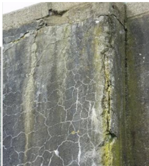
Figur 1:2: karaktäristiskt sprickmönster av ASR [9]
