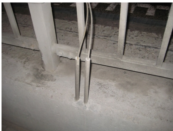
Figur 4 Inmonterade mätelektroder i stödmurens kantbalk (Essingeleden). Utstickande kablar skyddas av ett utvändigt plaströr.
