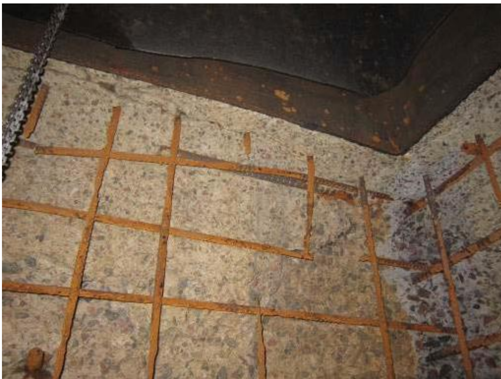
Figur 5.5 Vattenbilad yta vid reparation av utloppstuds 12, enligt [41].
