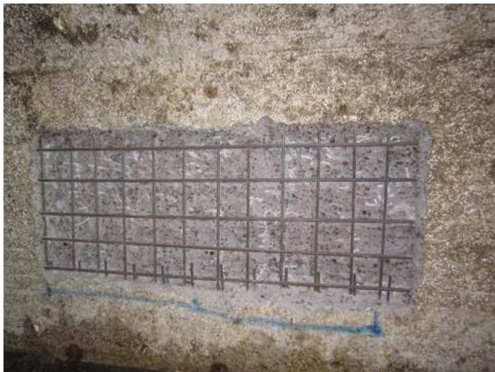
Figur 5.9 Frilagd armering på väggparti utloppstunneln med oskadad armering, enligt [41].
