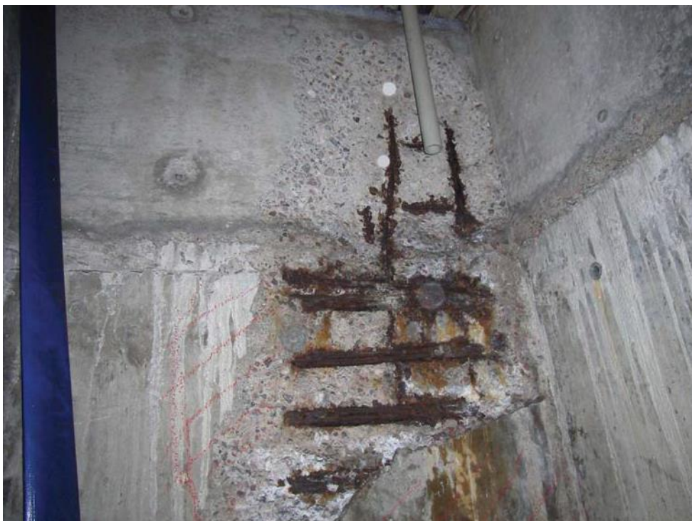
Figur 5.6 Spjälkad betong och kraftigt korroderad armering på dränageschakt 3, enligt [41].
