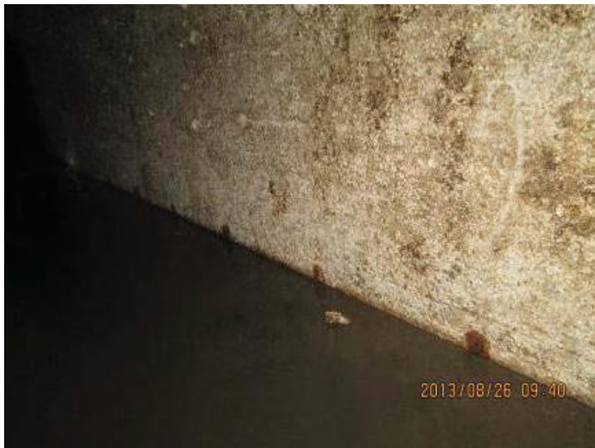
Figur 5.8 Rostutfällningar på tunnelvägg vid golv på utloppstunnel, enl. [41].
