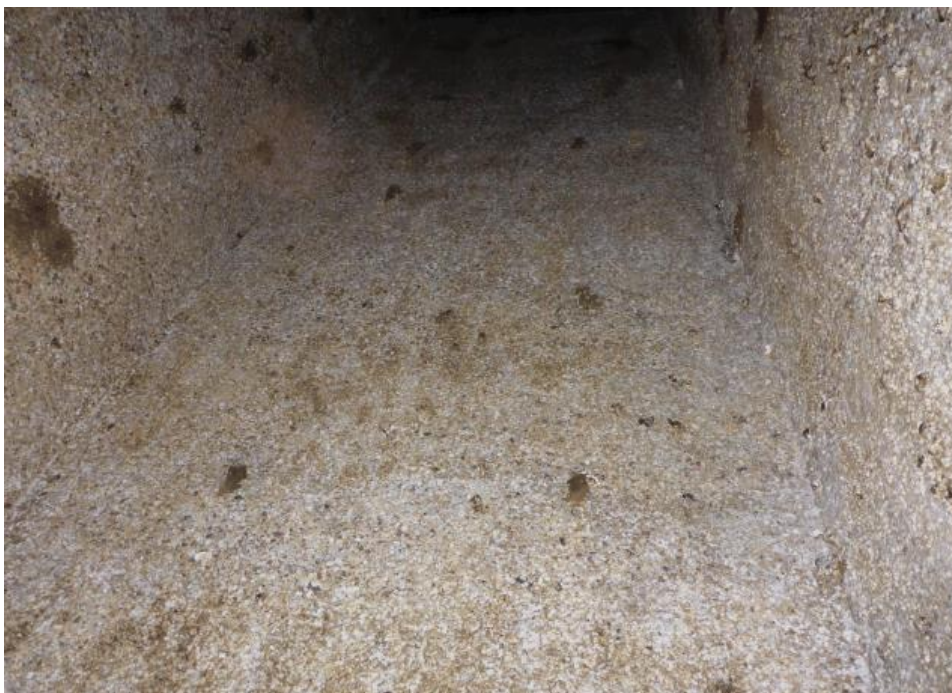
Figur 5.4 Bild på mindre rostutfällningar utloppstuds 8, enligt [41].
