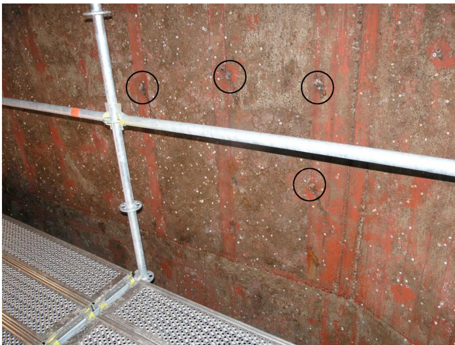
Figur 7.2 Rostutfällningar som troligen härrör från formstag, enligt [50].
