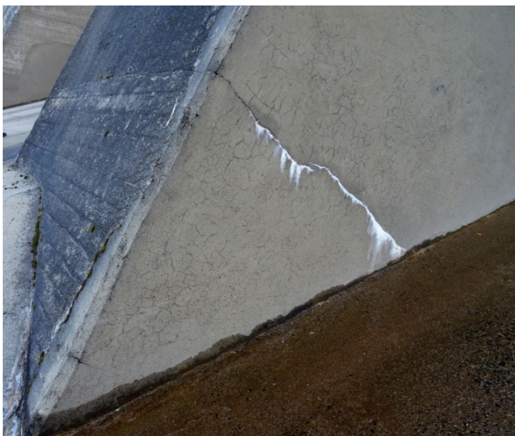
Figur 14. Spricka i dammtån av en utskovspelare.
