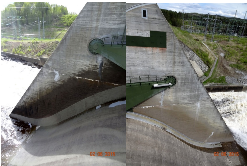
Figur 23. Pelare 1, vänster och höger sida.
