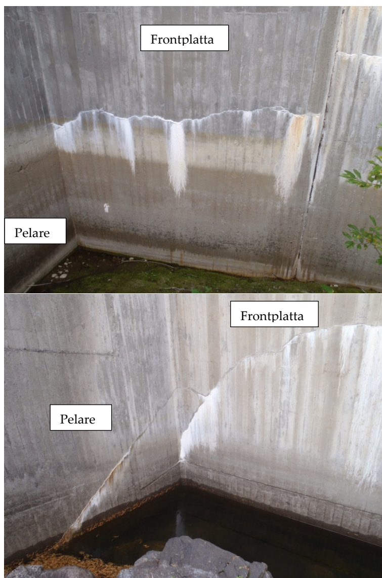
Figur 15. Horisontell spricka i frontplattan. A) endast i frontplatta. B) fortsätter in i pelaren.
