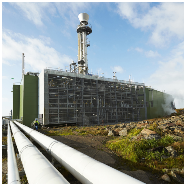
Göteborg Energis demonstrationsanläggning GoBiGas – termisk förgasning av skogsavfall.
