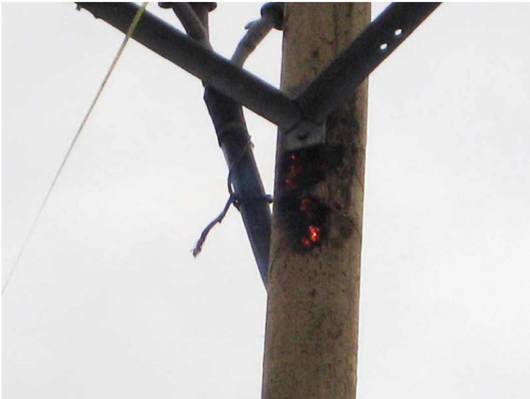
Bild 2 Brand i trästolpe under pålagd spänning på metallregeln
