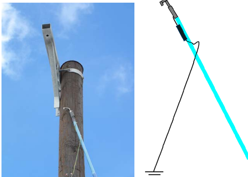
Bild 6 Stång för Metod svag jordning OBS säkringen.
