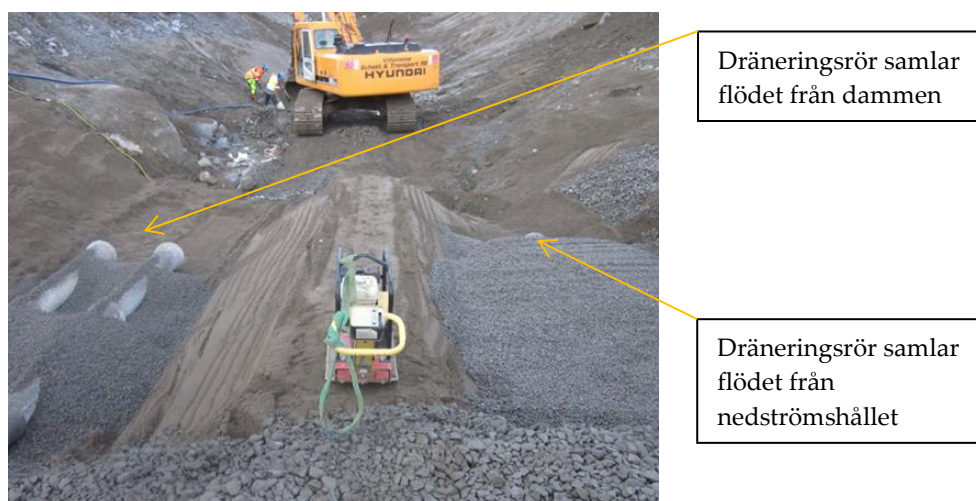
Figur 8.5 - 2 Dränage längs nedströms dammtå med avskiljning av från nedströmssidan inläckande vatten, som leds förbi den automatiska mätningen av läckagevattnet från dammen.
