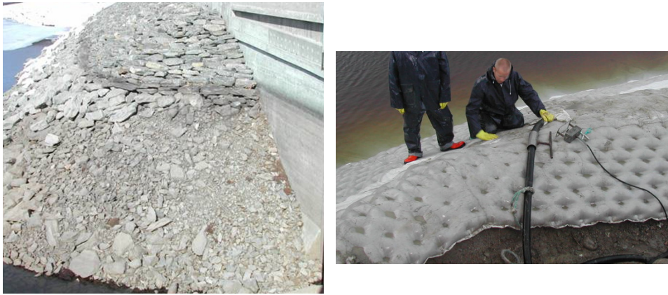
Figur 2.6 – 4 Exempel på skador på uppströms erosionsskydd vid utskov (vänster) och möjlig reparation med betongmadrass (höger).
