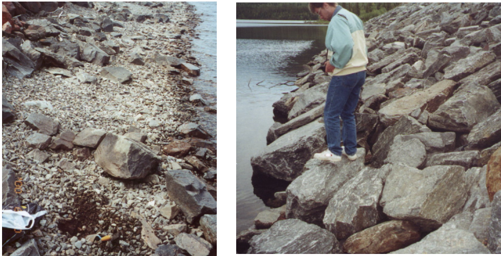
Figur 2.2 – 1 Exempel på skadat erosionsskydd (vänster) och nytt erosionsskydd ordnat med god kontakt mellan blocken, men utan orientering av blocken.
