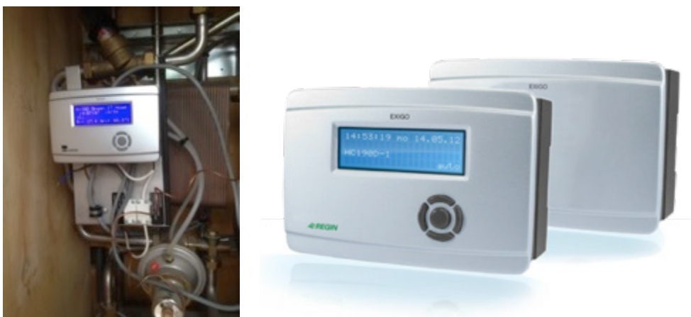
DUC (Digital Undercentral) typ Exigo installerad på Eriksbergsplatån. DUC:en monteras i samma rack som den manuella reglercentral som den ersätter.
