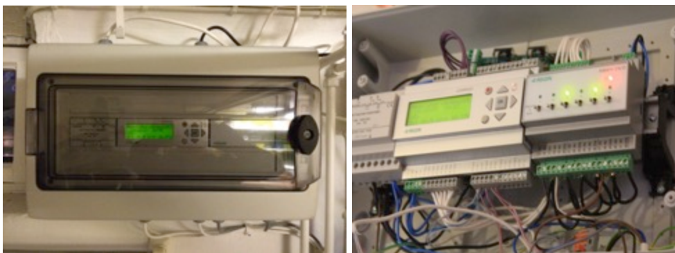
DUC (digital undercentral) typ Corigo installerad i separat apparatskåp bredvid fjärrvärmecentralen
