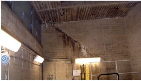
Spricktyp 1 – Sprickan har orsakats av temperaturgradient.
