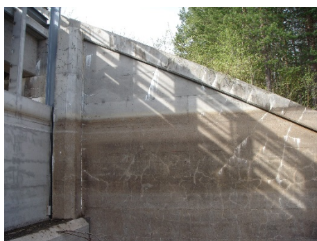
AKR skadat utskov. Sprickutvecklingen är mer markant i fuktutsatta områden.
