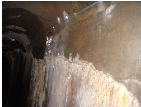
c) Urlakning genom en spricka, som troligen uppkommit p.g.a. förhindrade termiska rörelser.
