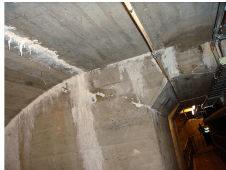
Spricktyp 1 - Sprickan har orsakats av temperaturgradient.
