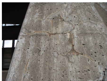
Typiskt sprickmönster vid AKR angrepp.
