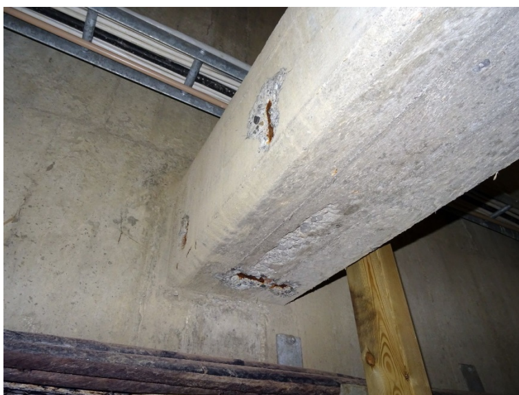
Figur 2-10 Armeringskorrosion i balk mellan frontplatta och klumpkonstruktion.
