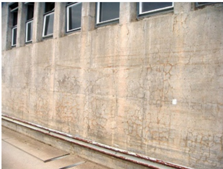
Figur 2-7 Yt-, temperatur och krympsprickor.
