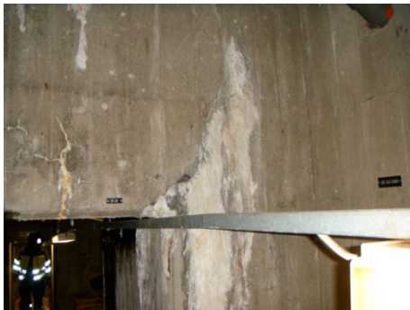
Spricktyp 1 - Sprickan har orsakats av temperaturgradient.
