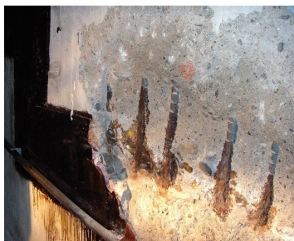
Armeringskorrosion orsakad av injekteringsmedel innehållande klorider, i en sprialkonstruktion i ett vattenkraftverk.
