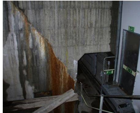
Spricktyp 1 - Sprickan har orsakats av temperaturgradient.
