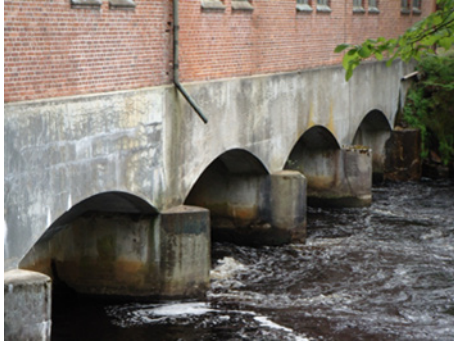
Sprickor initierade av plastisk krympning som har medfört frostangrepp på betong.
