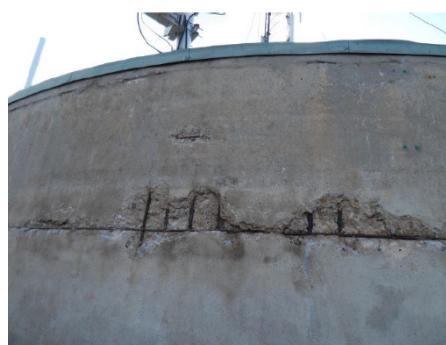
Armeringskorrosion orsakad av betongens karbonatisering Reparation av betongkonstruktioner, Nils Davant, CBI.
