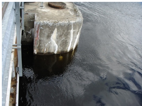
Inre frostska som har öppnat konstruktionen för urlakning. De av frostangreppet orsakade sprickorna urlakas i första hand.
