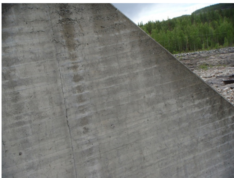
Figur 2-8 Ytsprickor i en dammpelare.
