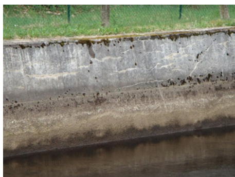
c) Inre frostskada ovanför vattenlinje, ytskador och urlakning under vattenlinje i en ledmur.
