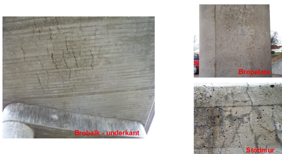
Figur 4-4 Järnvägsbro utsatt för AKR. Konstruktionen är en järnvägsbro. Brobalken som är spännarmerad i längdriktning har ett U-format tvärsnitt. Som framgår av figuren har sprickorna utvidgats vinkelrätt mot balkens längdriktning, d.v.s. spännarmeringen motverkar sprickutvidgning i spännarmeringens riktning.
