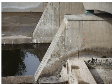
AKR skador i damm-/bropelare. Skadeutvecklingen är mest markant i de fuktutsatta områdena.
