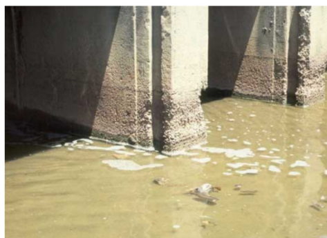
Karakteristisk nedbrytning av en betongbropylon i Pimpama River, sydöstra Queensland, orsakad av svavelsyran från sura sulfatjordar [21].
