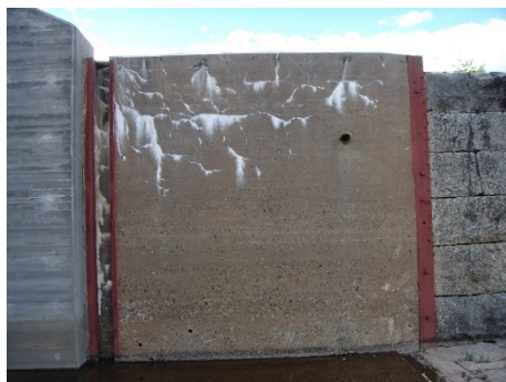
Betong skadad av AKR (inledande mekanism), frost och urlakning.
