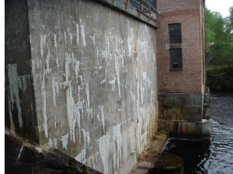
Sprickbildning som har uppstått mellan gjutpallarna. Anledningen är troligen termisk kontraktion av gjutpallarna.
