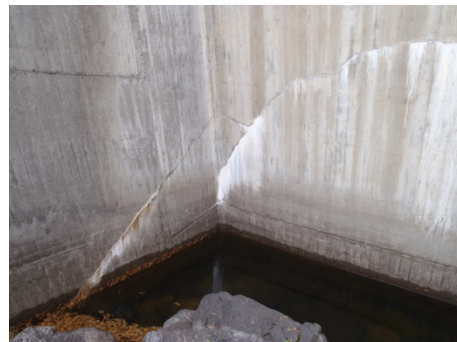
Spricktyp 1 - Sprickan har orsakats av att underlaget förhindrat rörelser som uppkommit p.g.a. temperaturvariationer.
