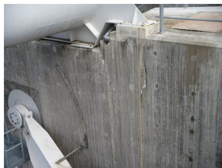
Skador orsakade av spänningskoncentration orsakad av sektionsförändringar samt tvång orsakadt av upplagskonstruktionen.
