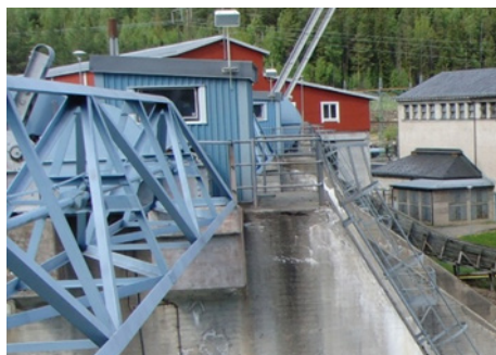
Frostskador i kombination med spänningskoncentration orsakad av sektionsförändringar.
