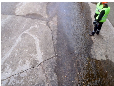
Utskovsplatta grundlagd på berg. Grova sprickor som är tecken på stort tvång och sprickanvisning samt otillräcklig armering.
