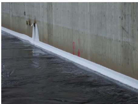
Isbildning på betongens yta under en kall vinter. Vattnet är inte fruset men det finns is på betongens yta både under och över vattenytan.
