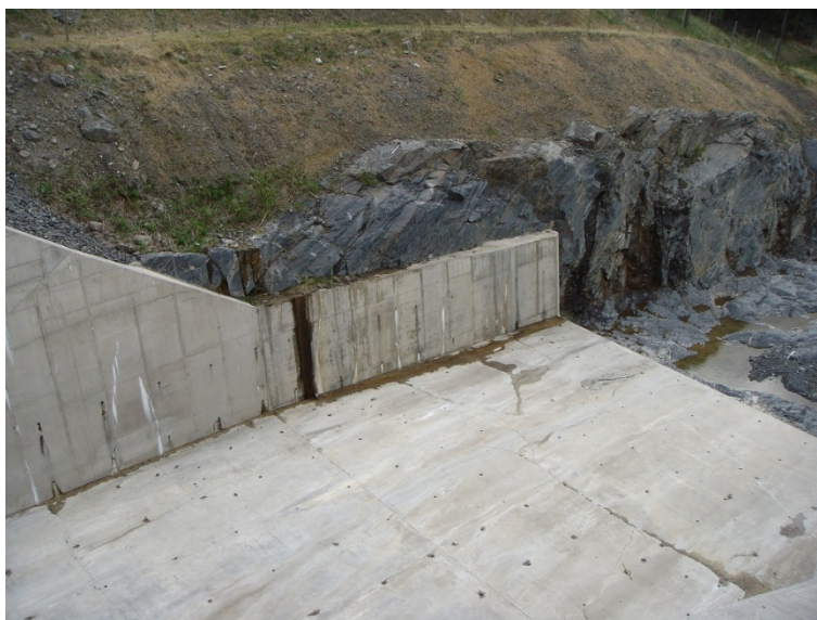
Figur 2-6 Temperatursprickor vid tidig ålder.
