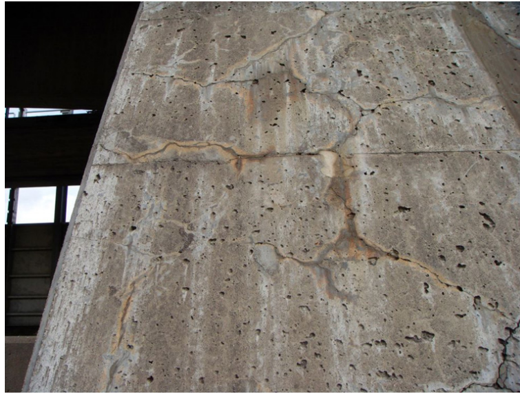
Figur 2-11 AKR skadad dammpelare.
