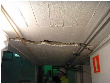
Sprickbildning p.g.a. sättning i en kraftstation
