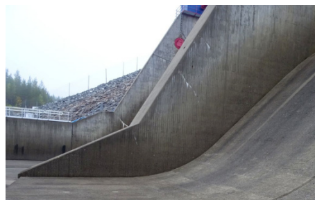
Spricktyp 5 – Sprickorna har orsakats av temperaturgradient.
