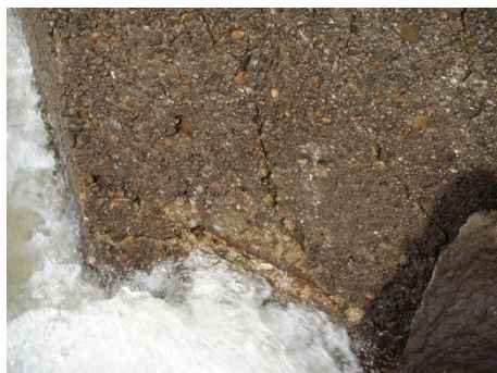
Betong skadad av AKR (inledande mekanism), frost och urlakning. Urlakningsprodukterna är eventuellt bortspolade.
