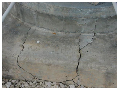
Sprickbildning på betongfundament orsakad av expansivt sulfatangrepp [22].
