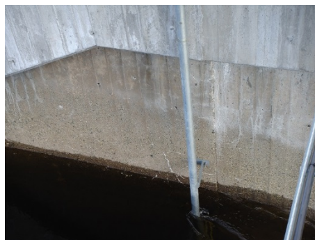
Betong skadad av AKR (inledande mekanism) och frost. AKR underlättar för utveckling av inre frostangrepp.
