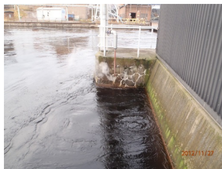
b) Inre frostskada vid intag till kraftverk.
