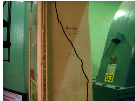
Sprickbildning p.g.a. sättning i en kraftstation
