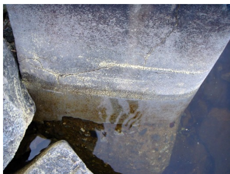
a) Inre frostskada i konstruktionsdel ovanför vattenlinjen. Avskalning av betongens yta under vattenlinjen.
