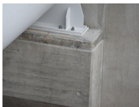
Sprickbildning orsakad av förhindrad krympning av upplagsbetongen.
