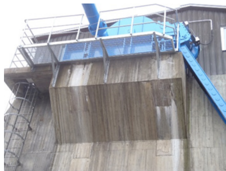
Skador orsakade av förhindrade temperaturrörlser, temperaturgradient samt spänningskoncentration orsakad av sektionsförändringar.
