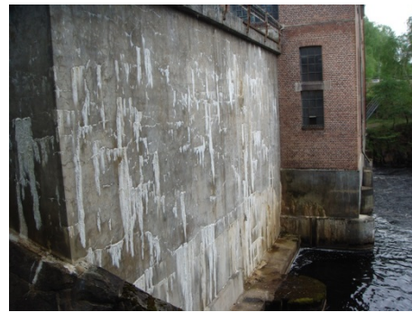
b) Urlakning genom sprickor är vanlig i gamla konstruktioner, där betongen komprimerades genom stampning eller otillräcklig vibrering.
