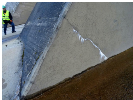
Spricktyp 5 - Sprickorna har orsakats av temperaturgradient samt tvång från underlaget.
