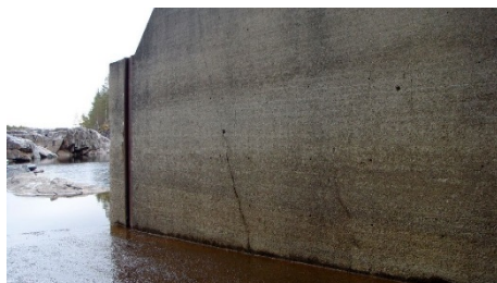
Ledmur vid ett utskov. Grova sprickor som är tecken på otillräcklig armering.
