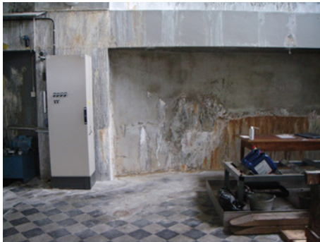
Sprickbildning av okänd anledning i en kraftstation.
