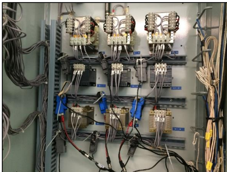
Figur 5: Placering av strömtänger (3 blå och 6 svarta) runt strömsignalerna till transformatorns differentialskydd. Alla strömsignaler kunde alltså fås ur samma ställverksfack.
