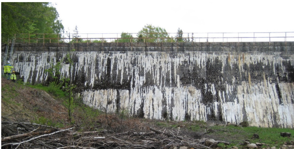
Figur 3. Utfällningar av kalk på nedströmssidan av en damm från 1900-talets tidiga år. Kalkutfällningarna har orsakats av genomsipprande vatten.
