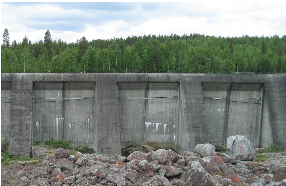
Figur 4. Enstaka sprickor i en betongdamm vilka orsakat mindre utfällningar till följd av genomsipprande vatten. Dammen är från 1960-talet.
