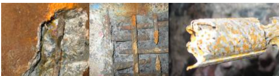
Figur 1. Exempel på utseendet av korrosionsskador hos frambildad stålarmering i kylvattenvägarna hos Oskarshamn 3.
