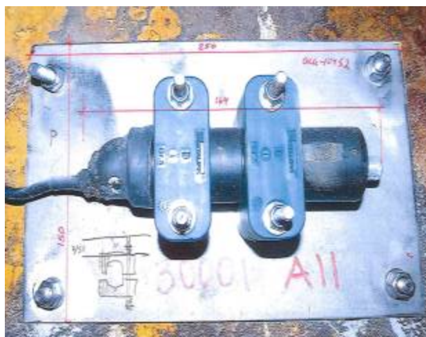
Figur 5. Exempel på en monterad potentiallogger med inbyggd referenselektrod av zink (Potentialloggerarna är monterade på inloppssidan) i kylkanal 441.L12 i O3.
