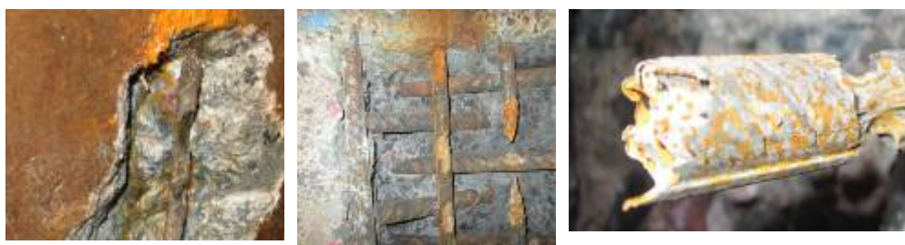
Figur 1. Exempel på utseendet av korrosionsskador hos frambildad stålarmering i kylvattenvägar (1)
