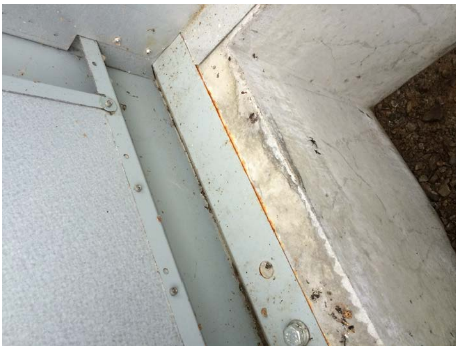
Foto 3 Nummer 9. Betongfundament men med korrosion på obehandlade plåtkanter.
