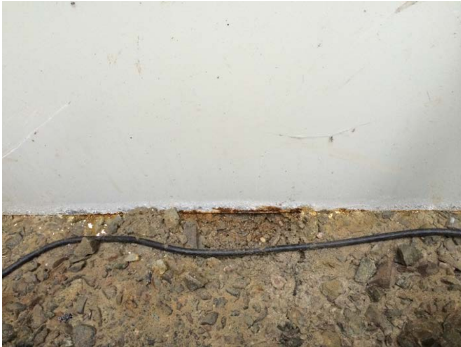
Foto 2 Nummer 8. Lite korrosion, "korrosionsgrad 3".
