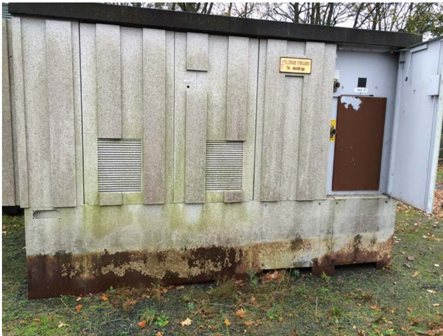
Foto 6 Nummer 25. Korrosion utsida på gammal station som tagits ur drift.
