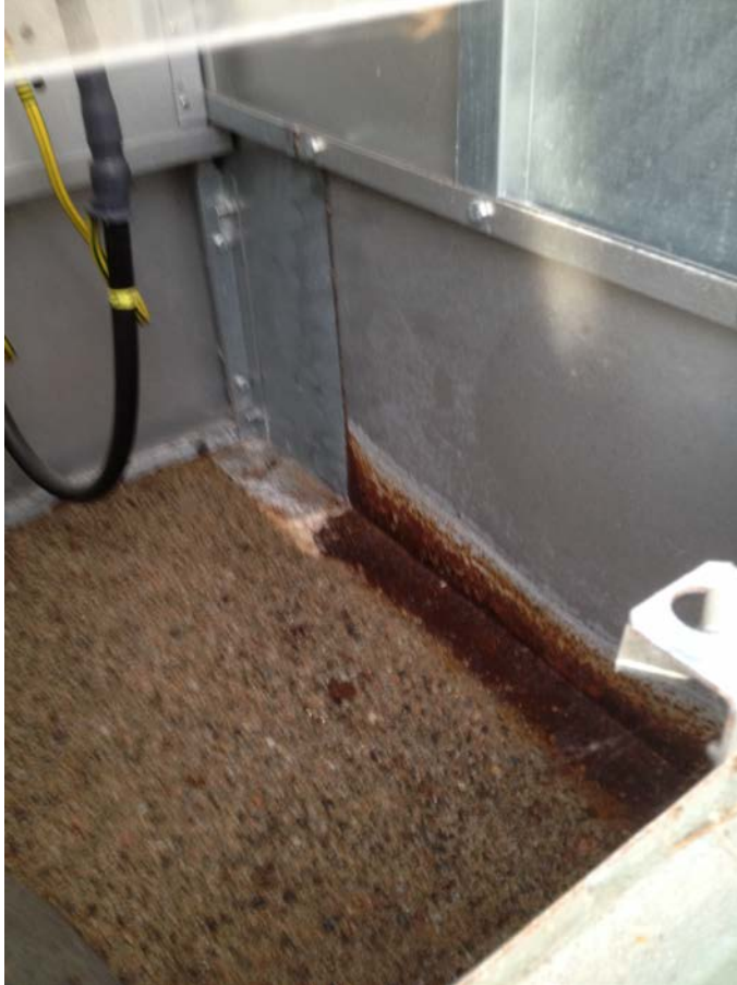
Foto 1 Nummer 1. Mycket korrosion, "korrosionsgrad 4", i nedre hörnet. Nästan ingen korrosion på en plåt i hörnet.
