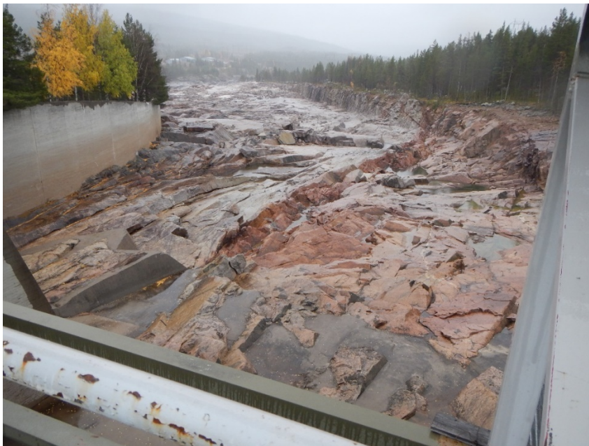
Figur 33 Harsprånget. Översiktsbild över utskovskanalen. Notera betongpålägningarna direkt nedströms utskovet utförda i svackor. Sprickzonen samt berggrundens storblockiga karaktär.
