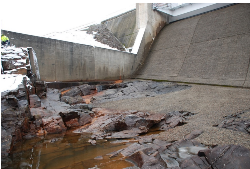
Figur 80 Krångfors. Bergytan nedströms höger utskov sedd från vänster in mot ledmuren. Notera de avhuggna linsformerna samt jättegrytorna.
