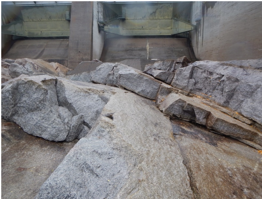
Figur 35 Harsprånget. Uppströms vy över vänster utskov. Notera de flacka sprickorna, spricköppningen samt avslitna block (syns på den brunfärgade vittringens avtagande in i blocken).
