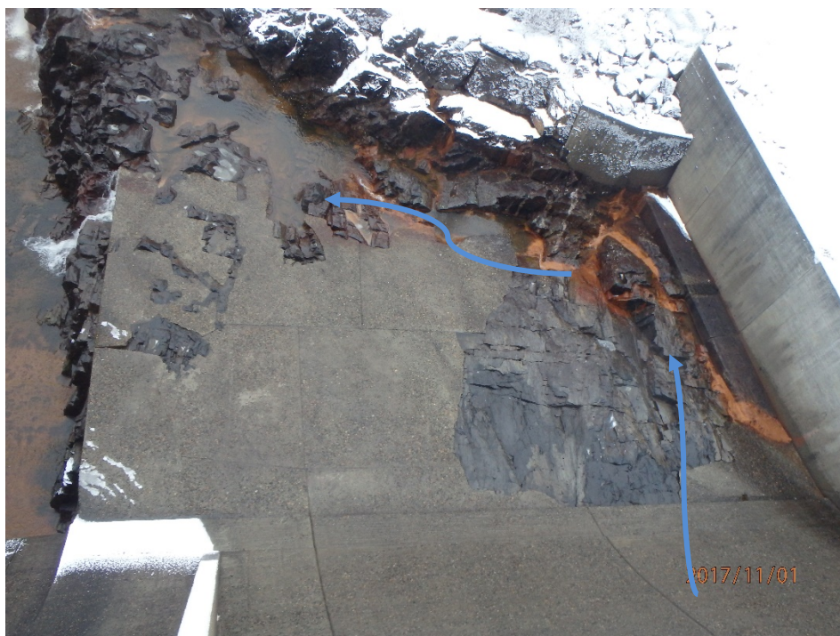
Figur 82: Området nedströms höger utskov i Krångfors. Vinkelrätt krök för vattnet, där det möter bergväggen. Foto: Norconsult, 2017.
