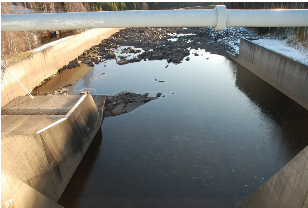
Figur 53 Båtfors. Utskovskanalen nedströms utskoven i Båtfors. Notera att spillvattnet har börjat undergräva ledmuren ungefär vid stegens läge.
