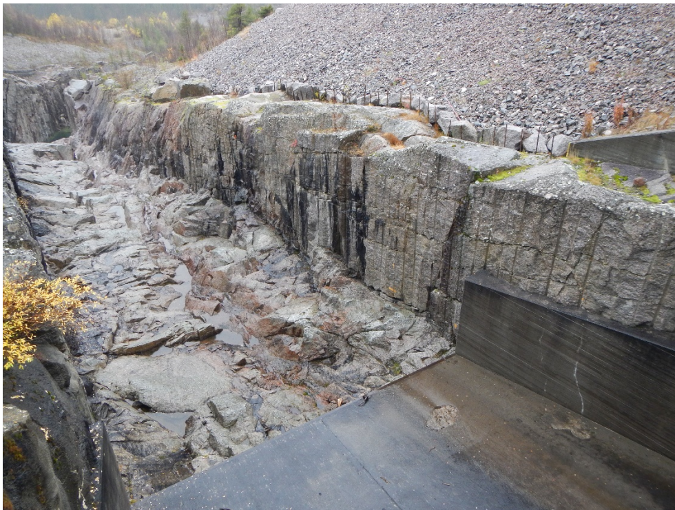
Figur 39 Seitevare. Utskovskanalen närmast utskovet. Notera sprickzonen. Rödfärgning närmast sprickzonen. Horisontella bankningsplan.
