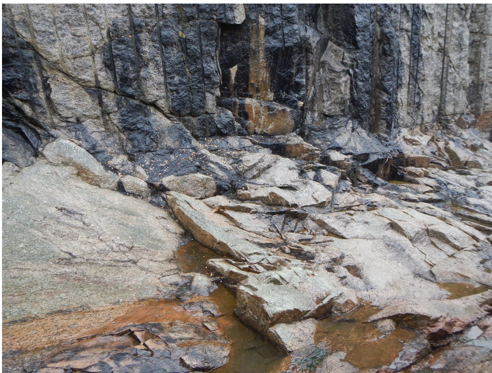
Figur 40 Seitevare. Vänster vägg och sula i utskovskanalen nära ( < 25\text{ m} ) slutet på skibordet. Notera de urfallna blocken i väggen. De flacka sprickorna i sulan.
