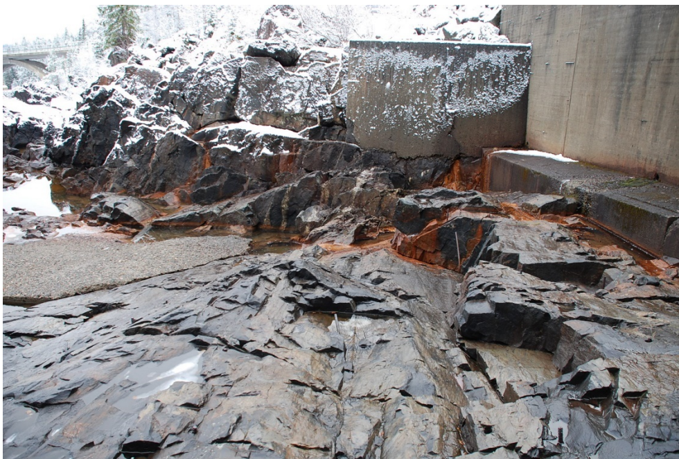
Figur 79 Krångfors. Bergytan nedströms höger utskov utan snötäcke. Notera de öppna bankningsplanen som följer linsformerna högs upp i bild, här i synfältet längs linsaxeln. Notera även foliationen och de bortslitna blocken till höger samt bergförstärkning.
