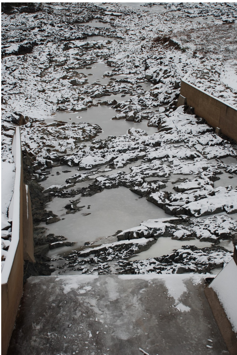
Figur 66 Grytfors. Översiktsbild över vänster del av utskovskanalen. Notera den dominerande strukturen tvärs kanalen samt de enstaka längre sprickorna längs kanalen.
