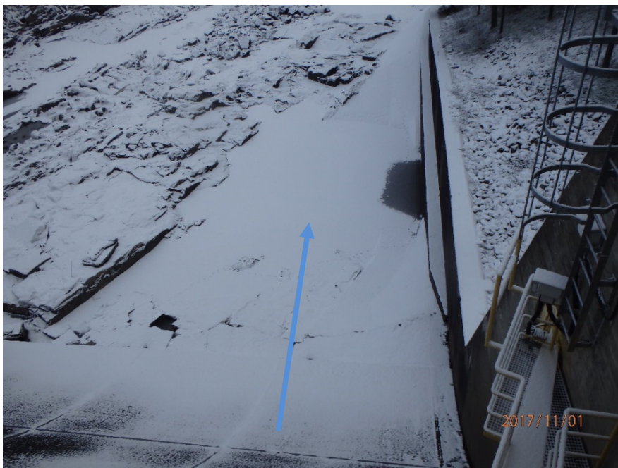
Figur 88: Utskovskanalen nedströms höger utskov i Selsfors. Foto: Norconsult, 2017.
