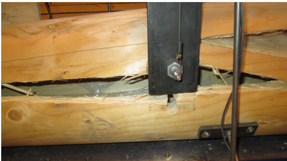
Figur 51: Utfall av provning - pinnbulten skär inledningsvis igenom stolpen för att sedan fläka upp stolpen (möjlig randeffekt).
