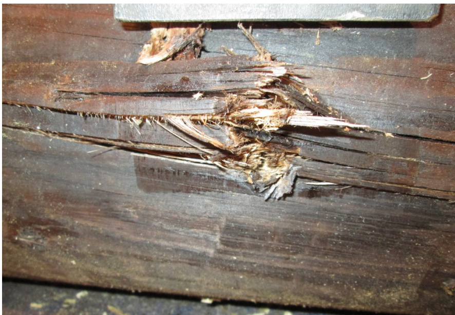
Figur 55: Utfall av provning - utdragning av skruv samt lokal skada kring skruvhålets mynning.
