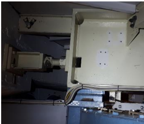
Figur 13 - Övre armkorsinfästning – Fast och odämpad - ger höga krafter från termisk utvidgning
