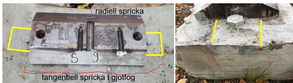
Figur 33 – Tangentiella och radiella sprickor nära ingjutna statorfundamentbalkar med plåt (gulmarkerat).
