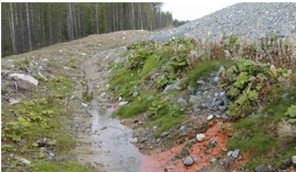
Figur 4 – 6 Källsprång i dammtån som saknar dammtåförstärkning.
