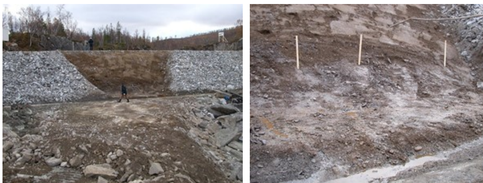
Figur 5 – 4 Stödbanken borttagen på dammens mittre del (vänster bild) och efter några få timmar uppstod källsprång ett par meter upp från nedströms dammtå (höger bild).
