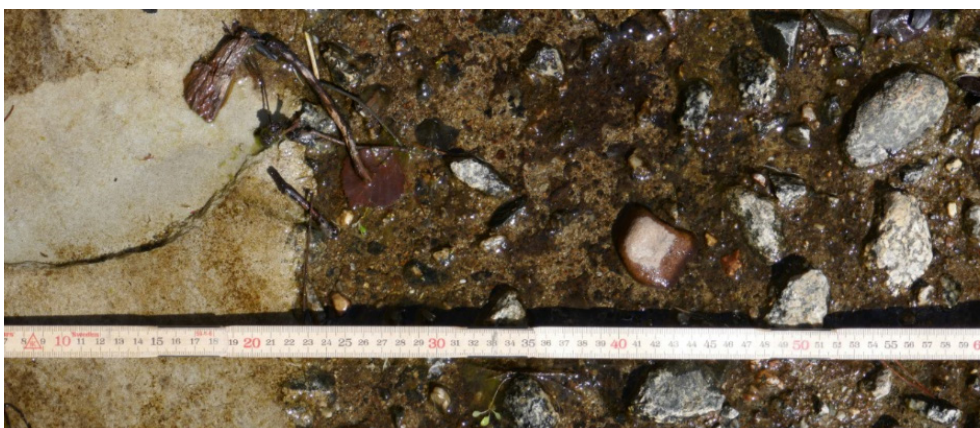
Figur 27. Mindre släppa i Chesterton-lagningen (t.v. i bilden) intill en plats där vatten troligtvis lätt blir stående. Tjockleken på den avbildade släppan uppskattas till cirka 5 mm.
