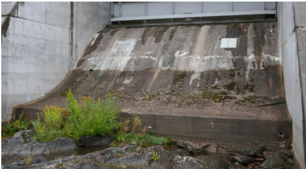
Figur 12. Nedströmsvy över skibord B vid kraftverk 1. Skibordet har lagats med sprutbetong.
