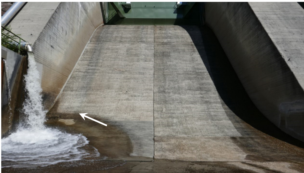
Figur 24. Nedströmsvy över skibord A vid kraftverk 3. Längsgående rörelsefog syns mitt i bilden. Vatten för minimitappningen släpps ut ned till höger där skibordet har reparerats med Chesterton-bruk. En skada i Chesterton-bruket har vid ett senare tillfälle lagats intill höger pelare (ljus område – se pil).
