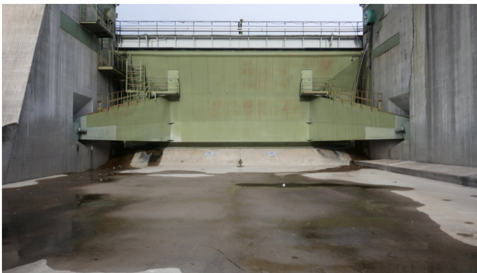
Figur 19. Nedströmsvy över skibord C vid kraftverk 2. Vatten blir stående på den närmast horisontella ytan.
