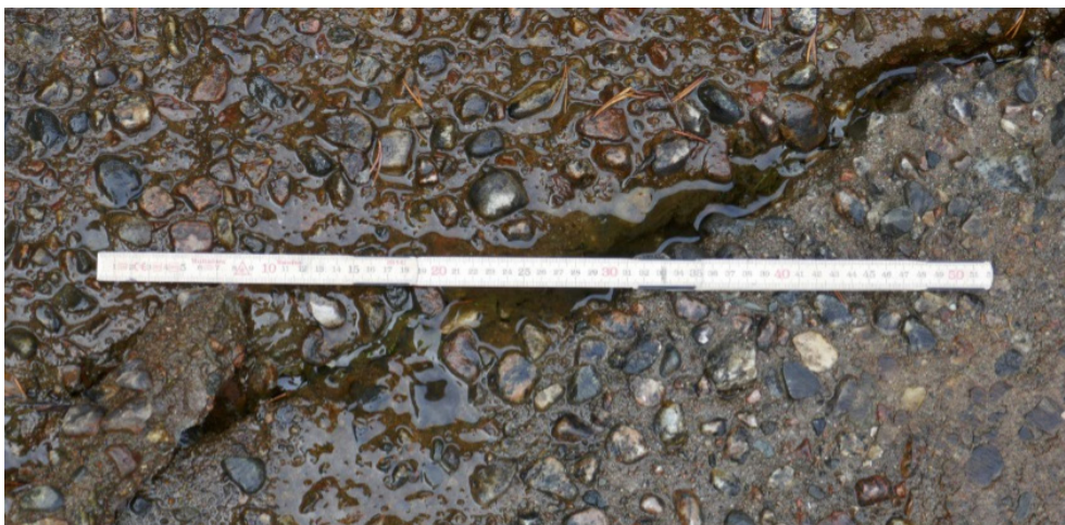
Figur 16. Nedbrytning av betongytan runt en rännil som korsas av en spricka. 50 cm tumstock som referens.
