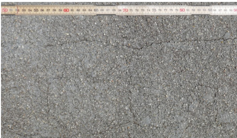
Figur 31. Krackeleringsmönster i Chesterton-bruket på skibord C vid kraftverk 3. Tumstock som referens.
