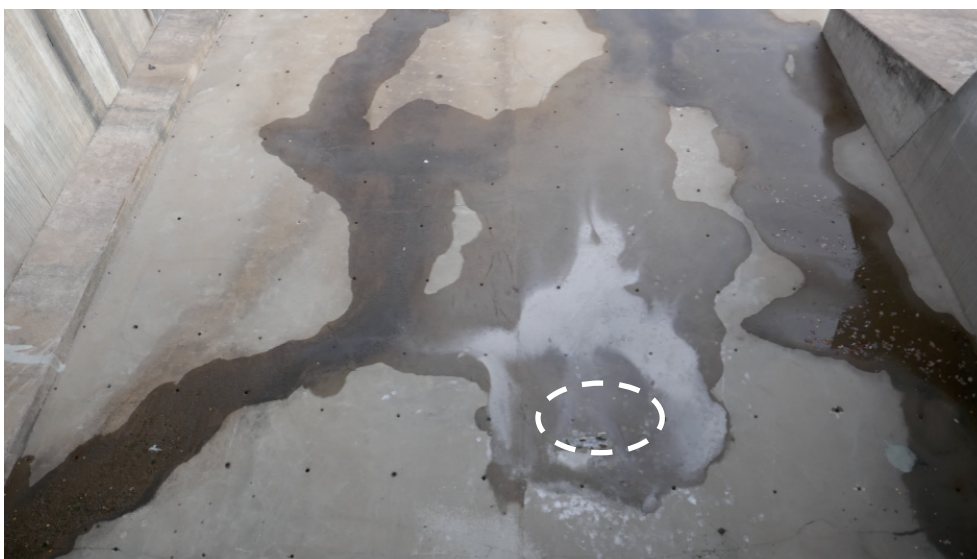
Figur 6. Inringat område markerar platsen för sex utborrade betongkärnor från den övre delen av skibord C vid kraftverk 2. Det inringade området inrymmer även borrhål från 2000 års uppföljning.
