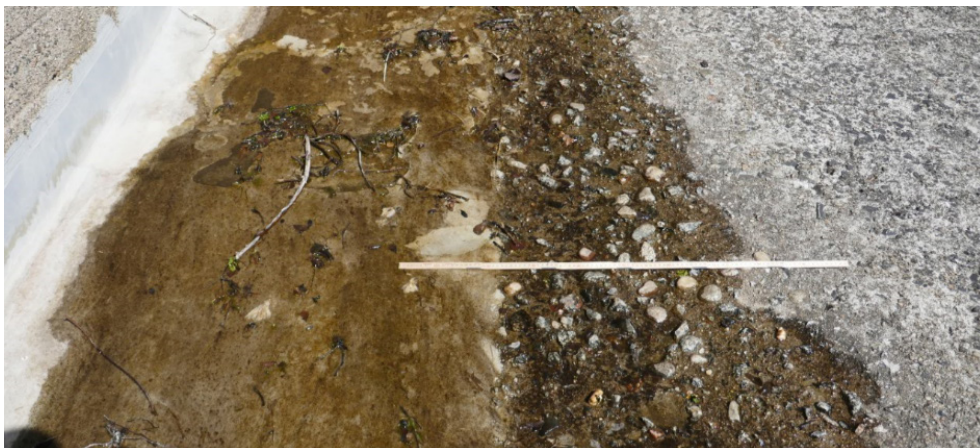
Figur 26. Frilagd grov ballast i ett stråk intill den 1 m breda Chesterton-lagningen. 1 m tumstock som referens.
