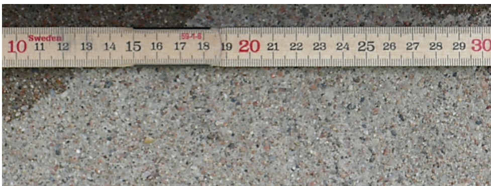
Figur 20. Representativt utseende på betongens yta där endast fint ballastmaterial har frilagts.
