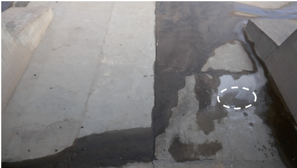
Figur 7. Inringat område markerar platsen för sex utborrade betongkärnor från den övre delen av skibord B vid kraftverk 2. Det inringade området inrymmer även borrhål från 2000 års uppföljning.
