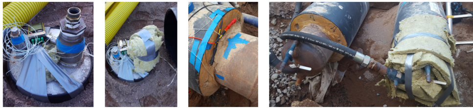
Figur 8. Foto 1 från vänster visar den oisolerade ventilen med TE under den blå tejp, foto 2 visar samma ventil men efter isolering (försök 3). Foto 3 visar röränden med TE på medierör och multimeter kopplad till koppartrådsändarna, foto 4 visar
