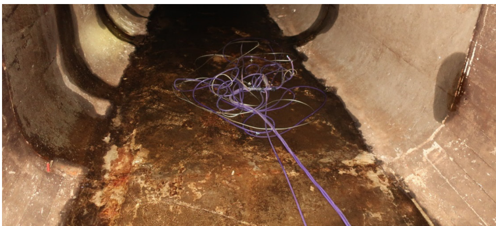
Figur 7. Det skadade kablagen till givarna T3 och T4 ligger på botten av tunneln efter provet. Detta förklarar att de under provets senare del visar mätvärden med oväntat höga statiska tryck.
