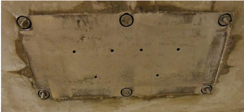
Figur 182. För att kunna demontera aluminiumplattan överborrades de ingjutna skruvarna som också var skruvade fast i aluminiumplattan. Därefter sattes skruvar i två av hålen i plattans mitt vilka pressade mot bakomliggande betong och när dessa drogs åt lossnade plattan.
