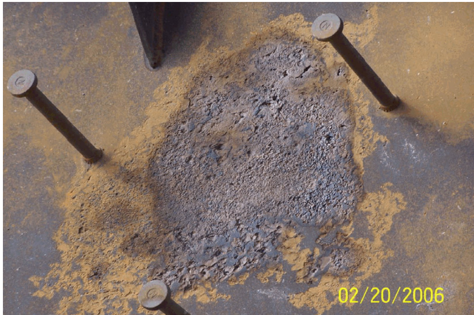
Figur 1a. Autentiskt rostangrepp på ingjuten linerplåt som har frilagts, varför korrosionsprodukterna är borta. Men i övre, vänstra kanten på den angripna ytan antyds den flakighet som skulle kunna medföra att korrosionsprodukterna uppträder olinjärt. Beaver Valley Unit 1 [6]
