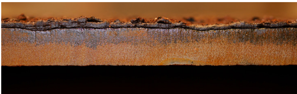
Figur 8. Tvärsnitt genom den skalkorroderade stålplåten framställt med hjälp av sand/vattenskärning. T.v. framträder den skiktning i rostlagret som kan misstänkas ge upphov till olinjäritet i korrosionsprodukternas akustiska egenskaper vid reflektion.
