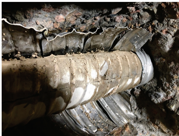
Figur 10 Avskuret foderrör och synligt injekteringsbruk som omger spännlinorna.
