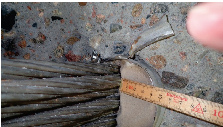
Figur 15 Placering av linor i ett horisontellt foderrör. De linor som är utanför foderröret är vattenbilade.
