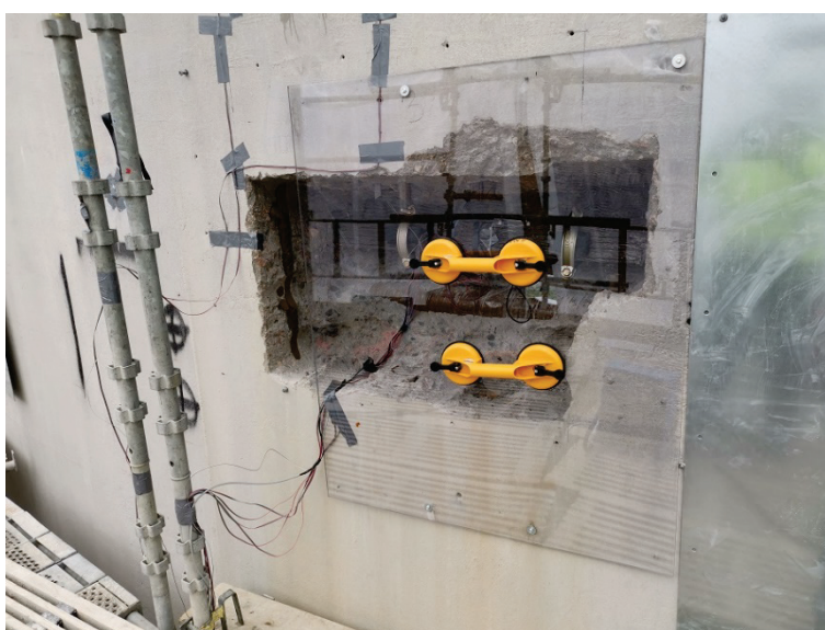
Figur 21 Skydd, tillverkat av plexiglas, mot gnistor och eventuellt okontrollerat linbrott vid kapning av linor.
