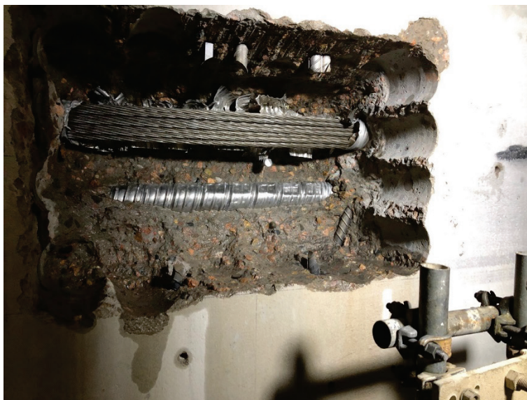
Figur 11 Synliga linor efter vattenbilning. Linorna tillhör kabel No 110 som misstogs för kabel No 109. Kapade vertikala slakarmeringsstänger är synliga i bilden.
