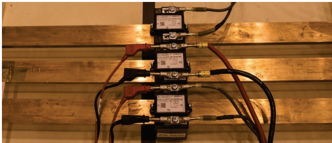
Figur 3 Uppkoppling med strömtransformatorer på rad
