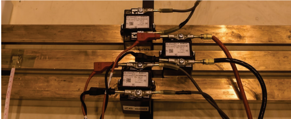
Figur 4 Uppkoppling med transformatorerna omlott
