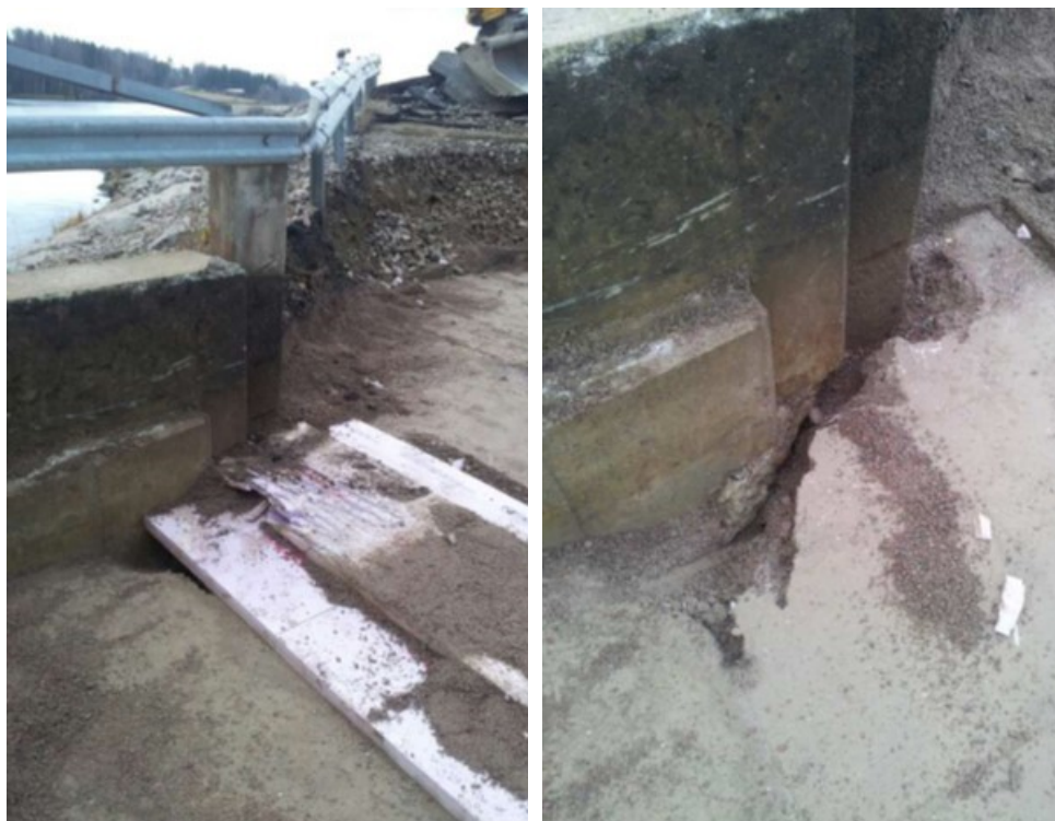
Figur 62. Sättning i vänster anslutning 2012.
