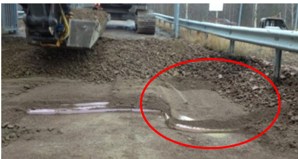
Figur 61. Sättning i höger anslutning 2012.
