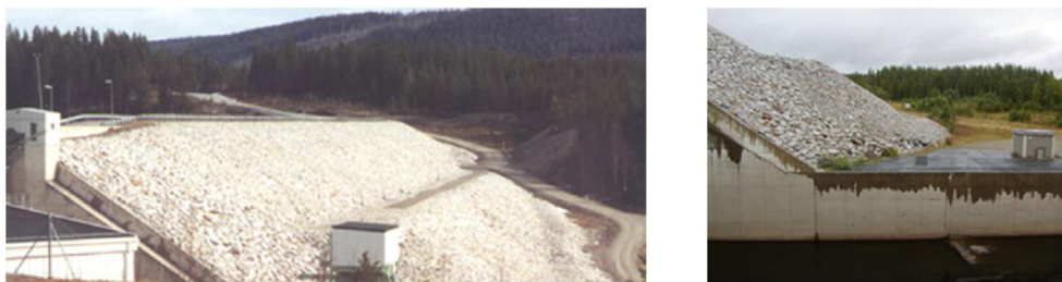
Figur 41. Vy över vänstra dammen vid anslutning efter uppbyggnad av stödbank intill betongkonstruktionen. Till höger syns mätkur över mätöverfall för insamling av läckage vid vänstra dammens anslutning till utskovet.
