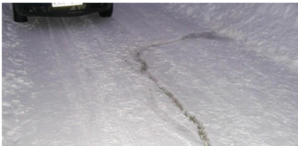
Figur 43. Spricka i vänster fyllningsdamm i anslutning till intagspartiet.
