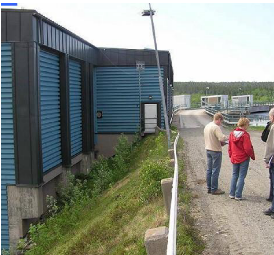
Figur 45. Vänstra fyllningsdammens anslutning. Lutande belysningsstolpe och vägräcke tyder på rörelser. FDU-besiktning.
