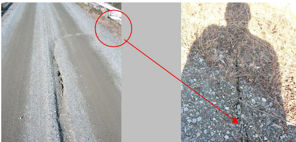
Figur 44. Spricka i vänster fyllningsdamm i anslutning till intagspartiet.
