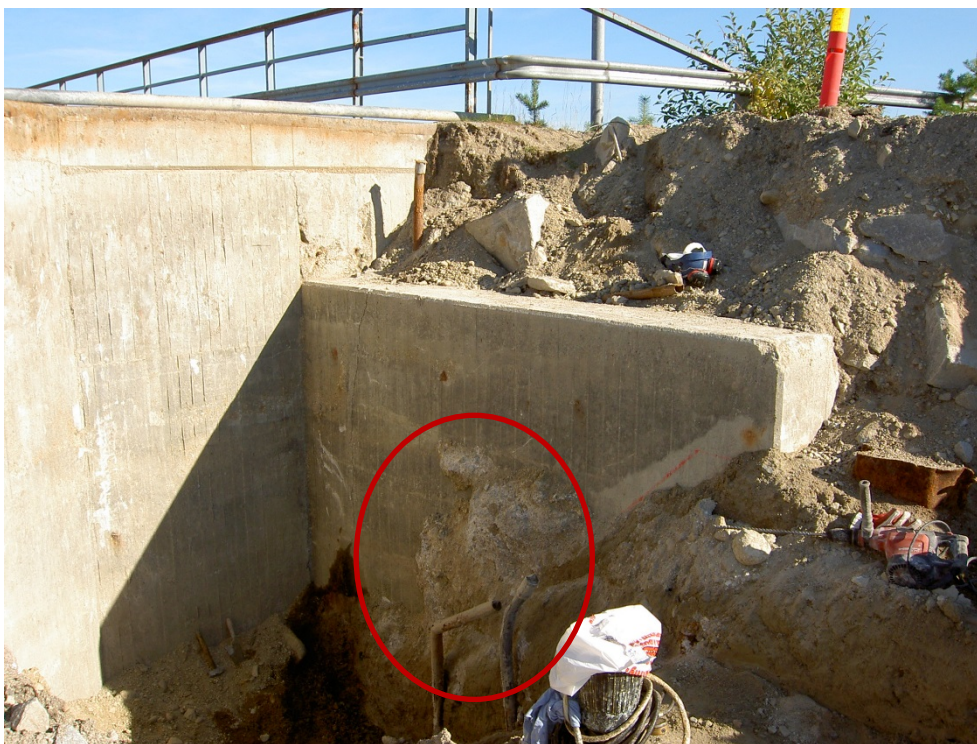
Figur 28. Gammal injektering och efterlämnade injekteringsrör (inom cirkeln) syns mot betongmuren (Foto: Carl-Oscar Nilsson)
