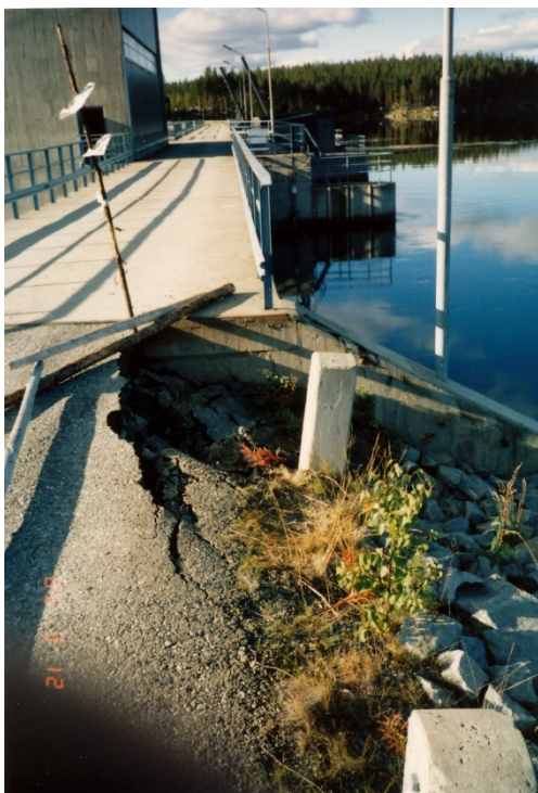
Figur 22. Sättning mellan fyllningsdamm och betong (Foto: Uniper).
