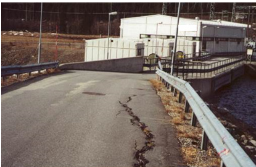
Figur 29. Sprickor i asfalten som visar att rörelser åt uppströmshållet förekom längs hela vänstra dammen. Sprickorna var störst i området närmast anslutningen till utskovet, 1999.
