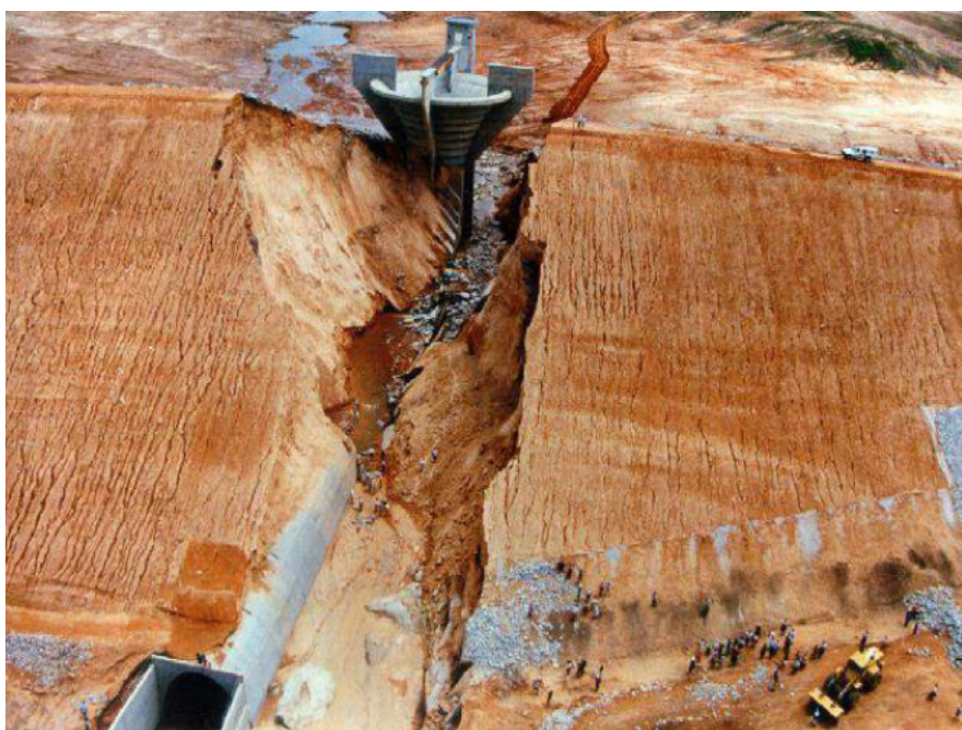
Figur 1. Dammhaveri orsakat av kontaktersion mellan damm och anslutning (utskovskulvert).
