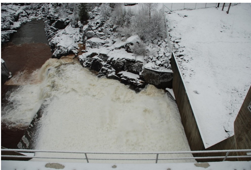
Figur 3.6 Mindre spillvattentappning ur höger utskov vid ett kraftverk i norra Norrland, se rapport 2018:532. Vattenmassorna lyfts ställvis upp av block som sticker upp ur skibordsförlängningen för att därefter slås emot nedströms bergvägg innan de rutschar ned i en centralt belägen spillfåra. Exemplet kan ses som ett typfall för hur ett enskilt block stötsida anfäktas av de framrusande vattenmassorna.
