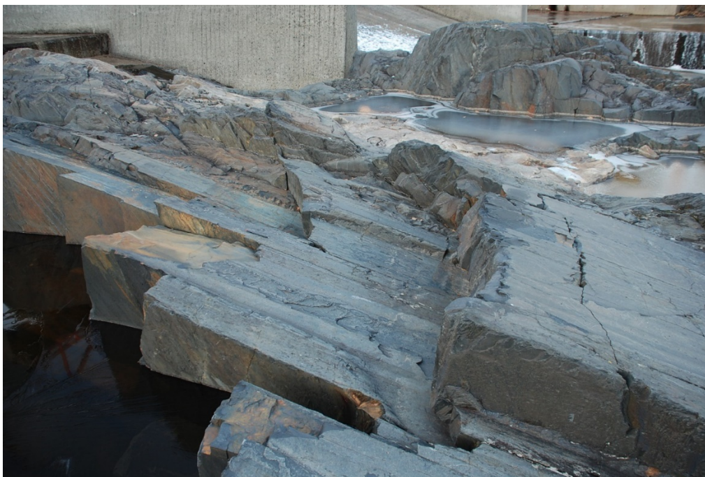
Figur 4.11 Fotografi från ett kraftverk i norra Norrland där sprickyterna i bergmassan ställvis var täta och ställvis uppgick till 1-2mm oberoende av stupning, se Energiforsk-rapport 2018:532. Bergarten här utgörs troligen av metamorf gråvacka. Bergmassan är veckad. Närmast utskovet på bild är bergmassan planärförskiffrad i två led.
