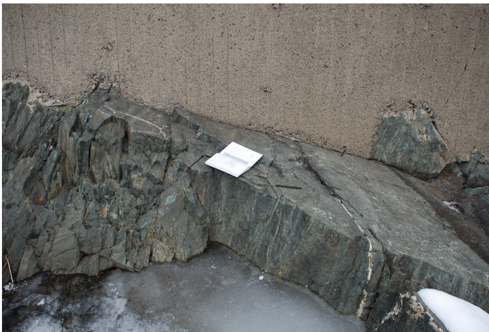
Figur 4.12 Fotografi från ett kraftverk i norra Norrland där sprickytorna i bergmassan ställvis var täta och ställvis uppgick till 1-2mm oberoende av stupning, se Energiforsk-rapport 2018:532. Här utgörs berggrunden av grönsten med tydligt planärförskiffring. Förskiffringen var ställvis tät för att ställvis uppvisa sprickor på 1-2mm. Notera även den plana uppsprickningen vinkelrätt förskiffringen.
