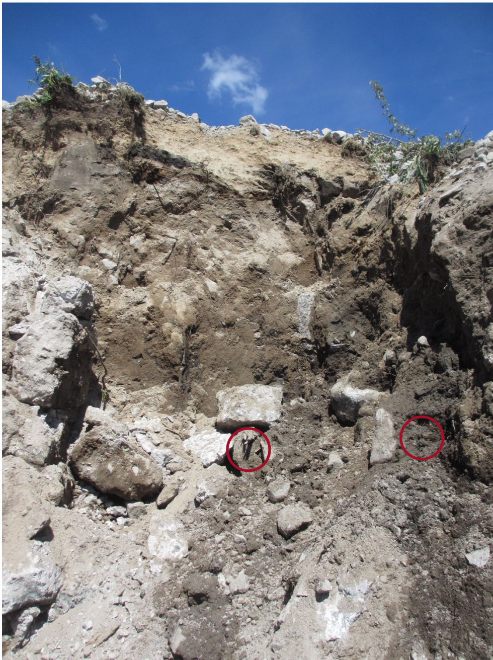
Fig. 26. Sista delen av anslutningens vingmur borttagen vilket frilade tätjorden vid anslutningen. Provtagning av tätjord utfördes vid de två inritade cirkklarna.
