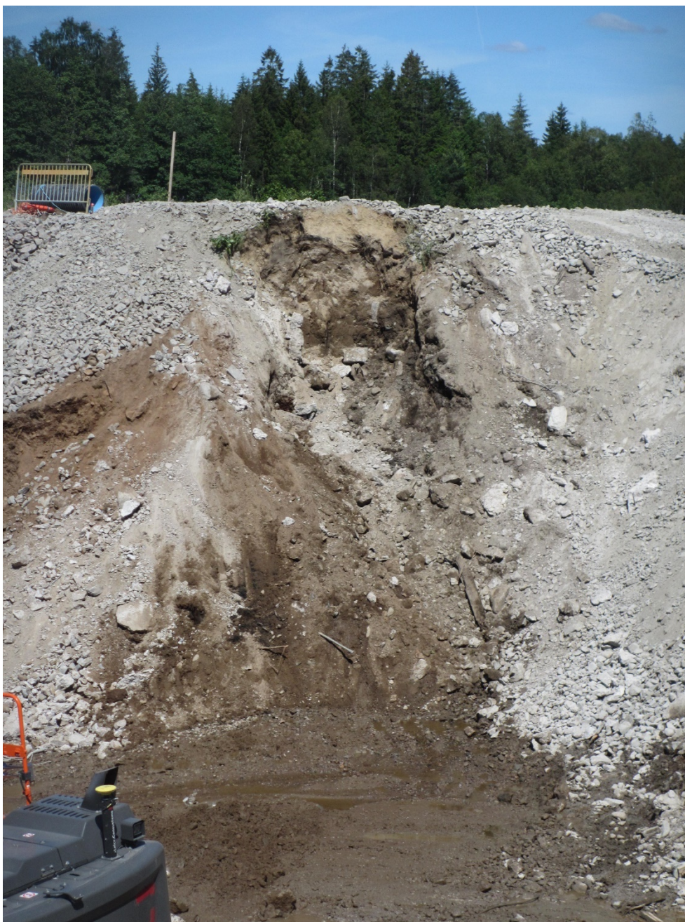
Fig. 20. Sista pelaren samt vingmuren helt riven. Foto taget från vänster anslutning mellan damm 17 och damm 16.
