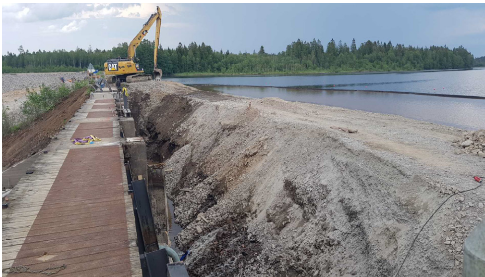
Fig. 6. Fångdamm som konstruerades uppströms damm 17. Foto taget mitt från damm 17. Schaktmaskinen står uppställd på den högra anslutningen mellan damm 17 och damm 18. Foto: Martin Rosenqvist 19 juni 2019.
