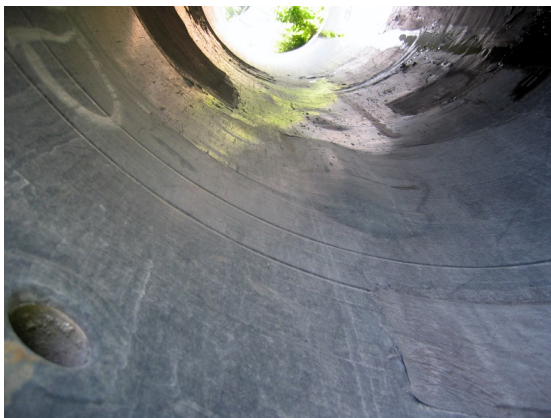
Bild 10a: Delaminering i skorstenen.
