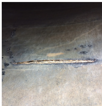
Bild 6b. Spricka i spärrskiktet i samband med delaminering som exponerar underliggande styrkelaminat.
