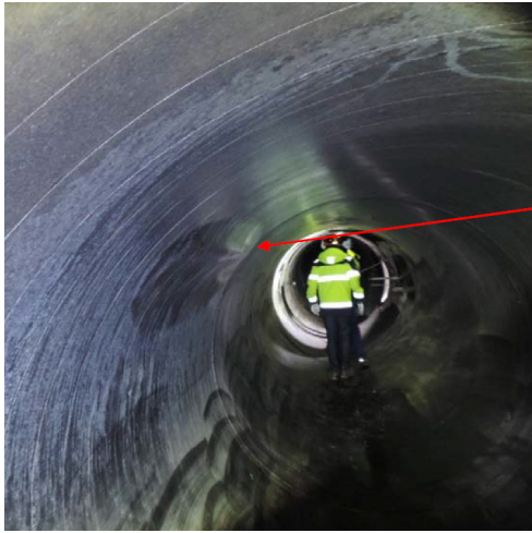
Bild 8a. Delaminering i rökgaskanalen indikerad med röd pil.
