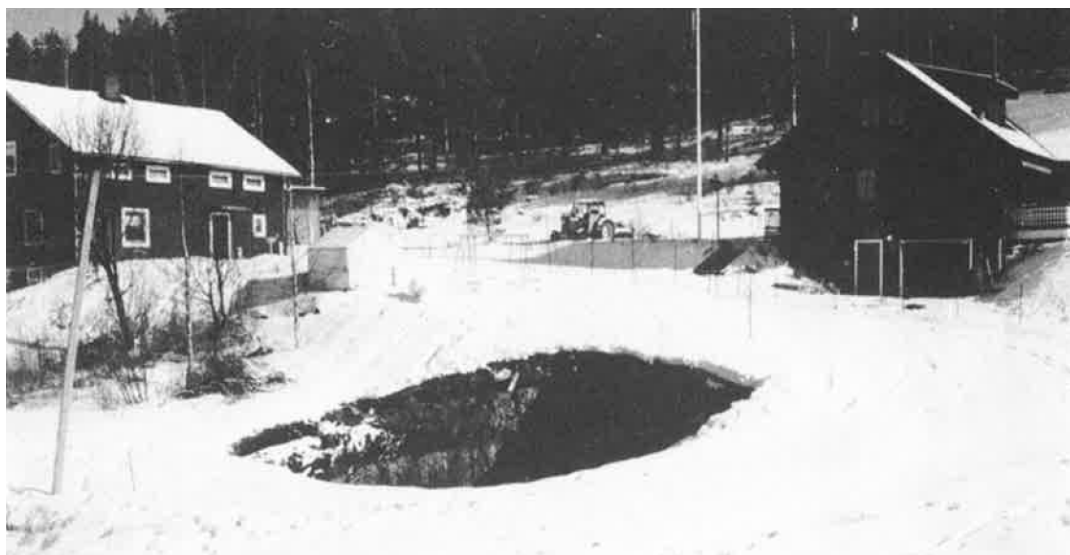
Figur 2: Ras i en utloppstunnel som har nått ända upp till markytan. Hultman et al (1993).
