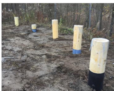
Ecopole pollare vid utsättning vid Vattenfalls ställverk i Sjömarken 2015-11-02
