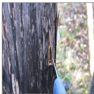
Delaminering i ytan av stolpe nr 1
