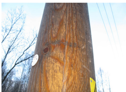
Stolpe 120356. Längsgående sprickor i fanéren
