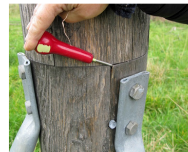
Stolpe nr 11. Delaminering vid skarv
