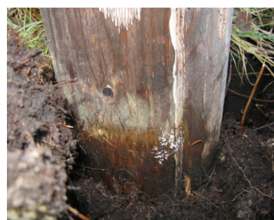
Stolpe 120358. Mycket fuktigt under markbandet. Synlig påväxt av svampmycel
