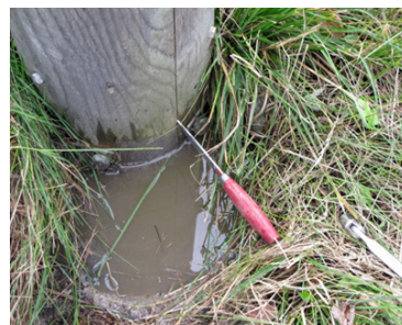
Stolpe nr 9. Fritt vatten under markbandet
