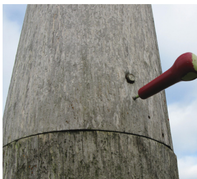
Stolpe 095. Fuktfälla p g a att nedre sektionen sticker ut något jämfört med övre sektionen
