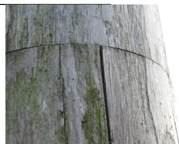
Stolpe 109. Spricka och delaminering
