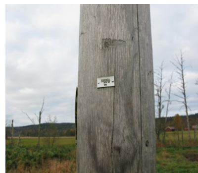
Stolpe 086. Flera längsgående sprickor
