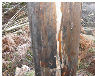
Stolpe 120444 uppvisade begynnande delaminering
