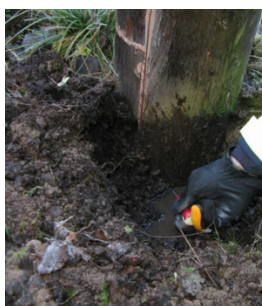
Stolpe 120356. Stolpen står i vattensjuk mark
