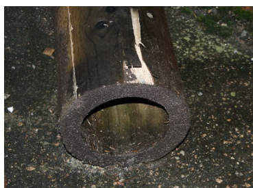
Angrepp av missfärgande svamp på insidan i rotänden av stolpen
