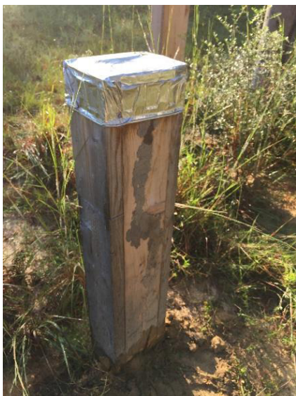
Figur 10. Kontrollstolpe med termitangrepp.
