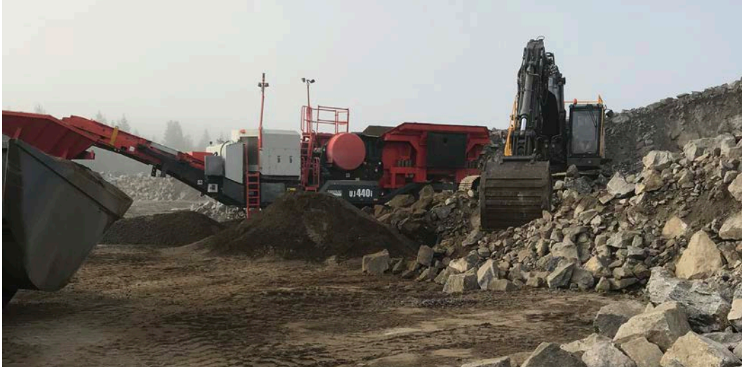
Figur 10. Tillredning av överbyggnadsmaterial av bergkross och aska. Grävaren till höger portionerar bergmaterial och aska enligt recept.
