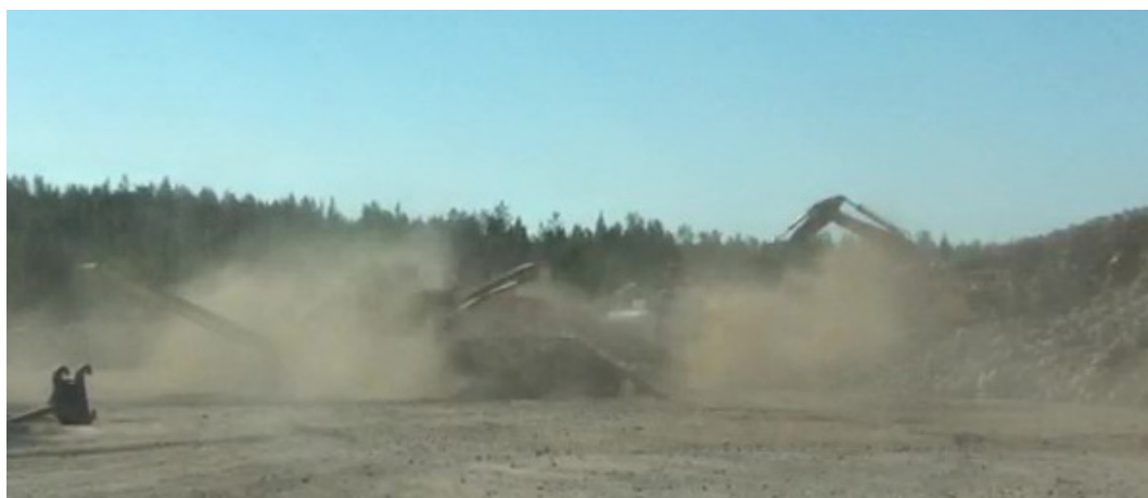
Figur A5. Bilder visar damningsproblematiken som uppstod vid askinblandning i krossverket.
