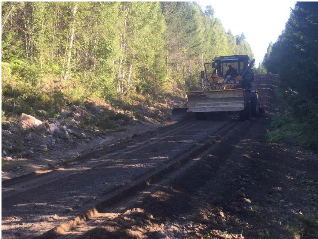
Figur A8. Blandning med hyvel på testväg 1. Materialet blandas från sida till sida.
