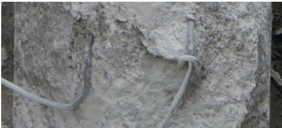
Figur 115. Pelare 11. Inborrat tväråsat armeringsjärn med ändkrok omsluter armeringen i 1940-talsbetongen.
