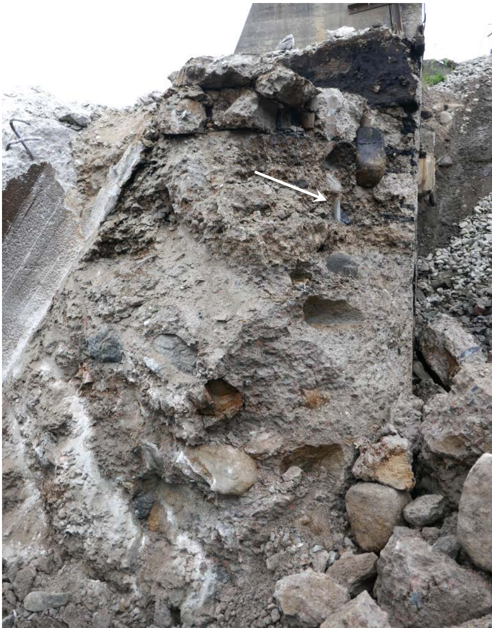
Figur 108. Pelare 12 – sidovy. Inblick i pelarens inre efter att den intilliggande utskovströskeln med tillhörande skibord i utskov 11 hade rivits ut. Notera det med friskt injekteringsbruk igenfyllda borrhålet US (vit pil).
