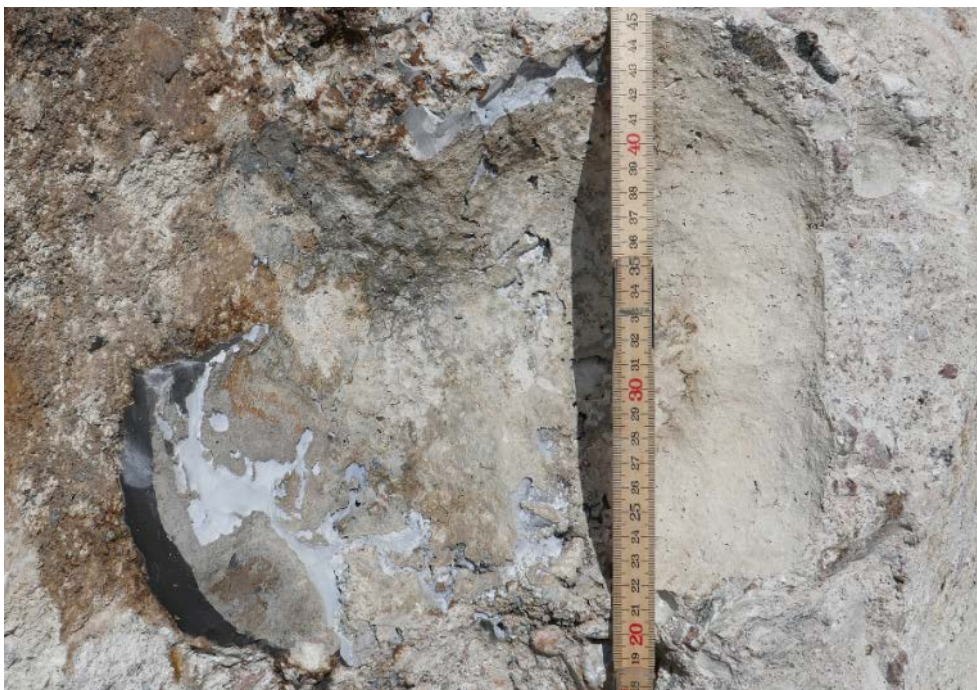
Figur 112. Friskt injekteringsbruk runt bortfallen sparsten. Intill fanns det kraftigt urlakad betong (brunfärgad).
