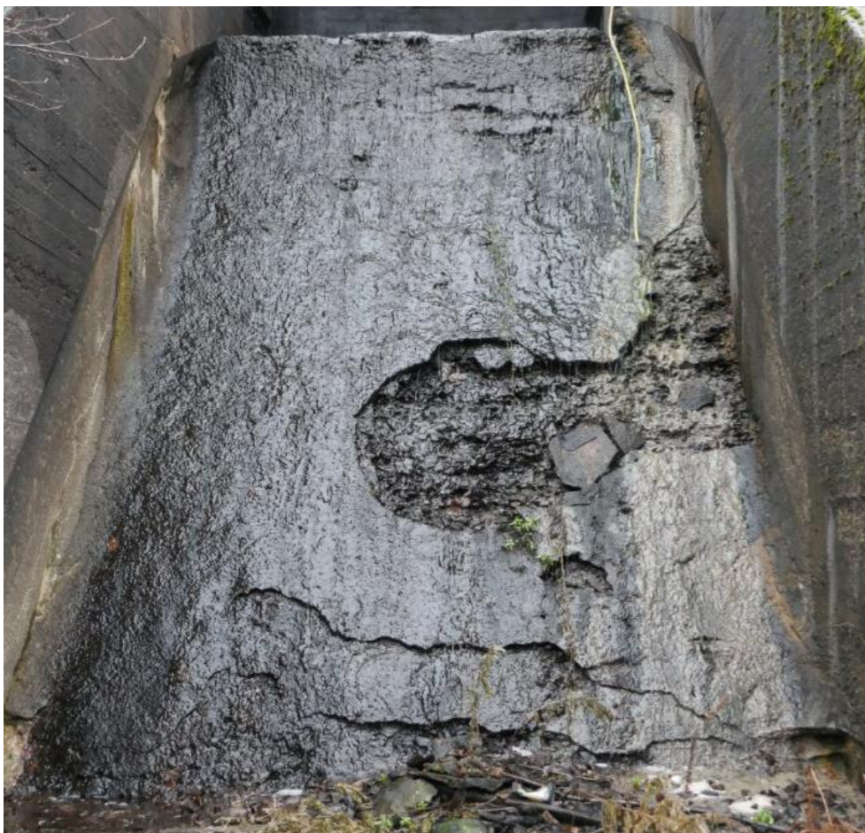
Figur 30. Det brant lutande skibordet i utskov 12. Skador med olika omfattning har uppkommit i lagningen.
