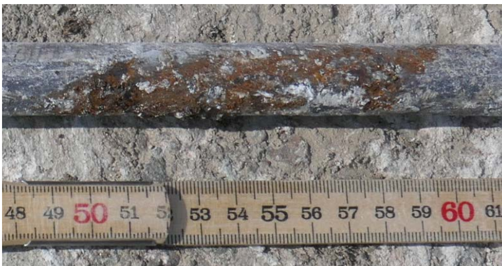
Figur 122. Närbild på förekommande ytrost på det tvärsade armeringsjärnet i Figur 117.
