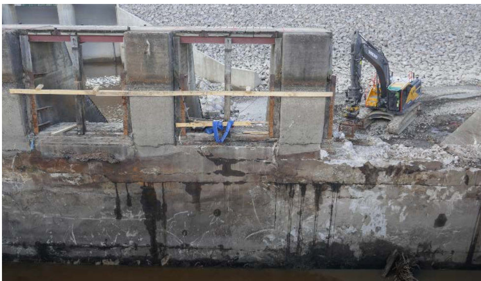
Figur 90. Mörka stråk noterades på dammens uppströmsida efter att pelartoppen till stödpelare 11 hade välts ned. De mörka stråken antogs vara vatten som hade pressats ut ur dammen genom de horisontella sprickorna.
