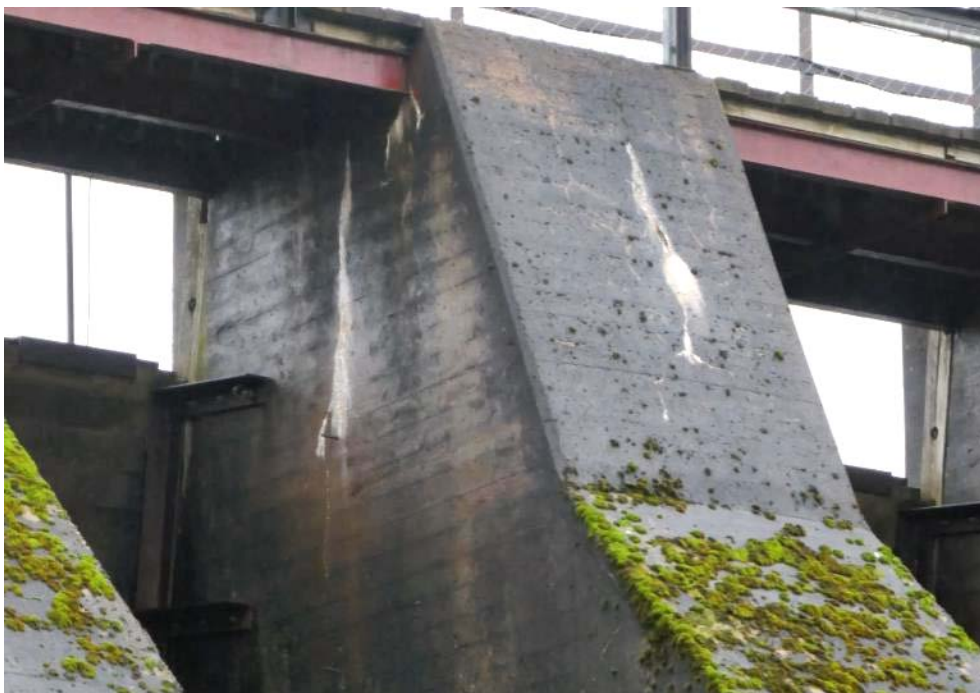
Figur 38. Pelare 9. Vertikala sprickor med vit kalkutfällning på höger respektive nedströms sida av pelaren.
