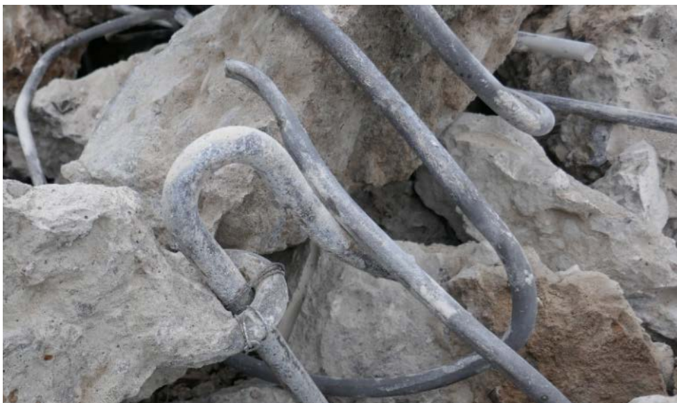
Figur 114. Armeringen som påträffades vid rivningen kunde uteslutande härledas till 1940-talets pågjutningar.
