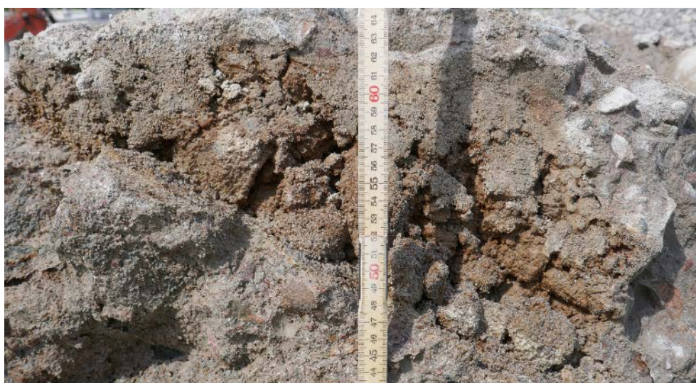
Figur 104. Ställvis var brottytorna sandiga, vilket indikerar att betongen har urlakats över tid.
