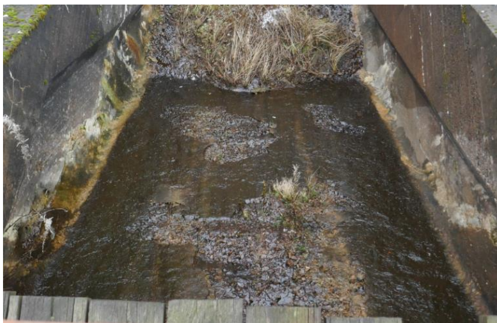
Figur 33. Efter sju år har skadorna på skibordet i utskov 6 växt ytterligare. Fotografiet togs i november 2018.
