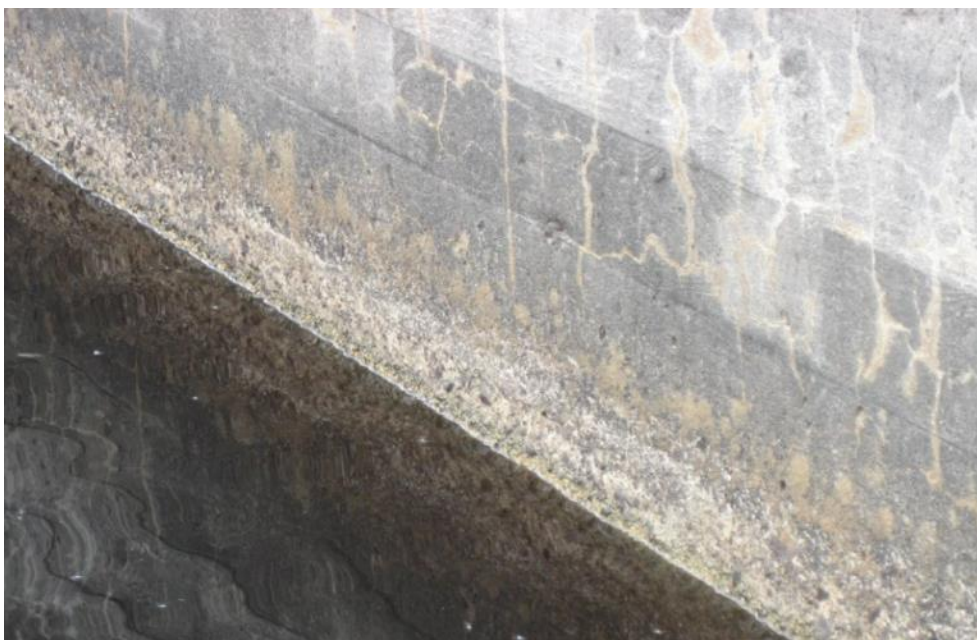
Figur 44. Närbild på betongens yta längs vattenlinjen. Endast mindre avskalningar av ytan kan noteras. Ställvis förekommer även ett sprickmönster med vit- och brunfärgade utfällningar.
