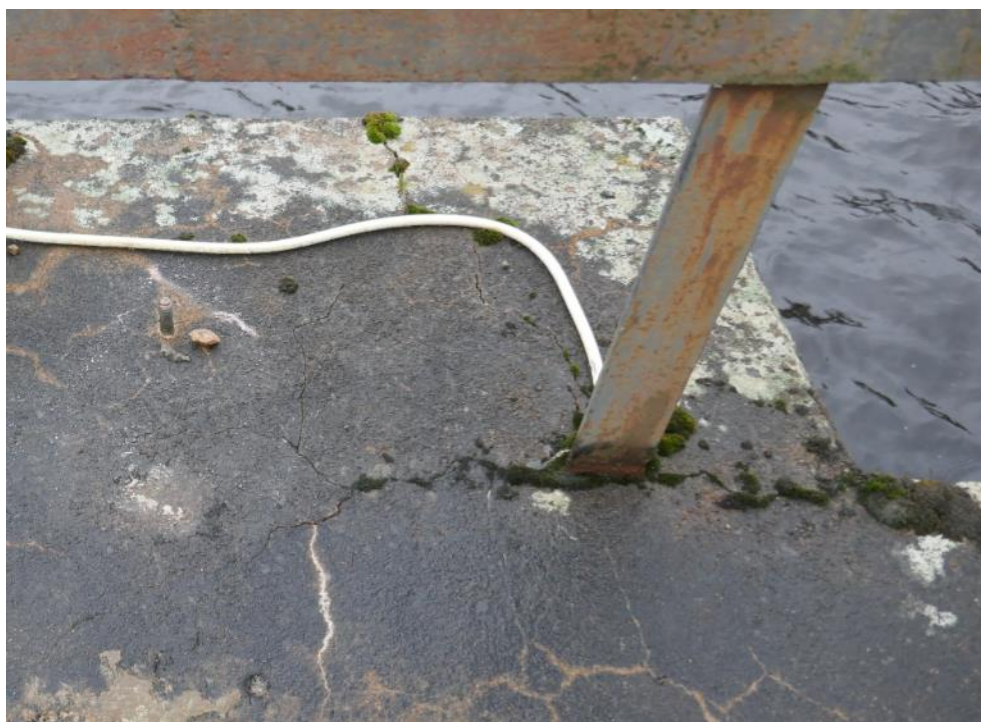
Figur 46. Pelare 7. Sprickor med olika orientering som utgår från den ingjutna räckesstolpen.
