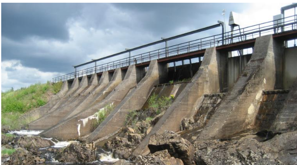
Figur 25. Utskovsdammens nedströmssida fotograferad i maj 2011. Från håll kan en lång och sned spricka med vita kalkutfällningar noteras på vänster sida av stödpelare 7. Det syns även att skiborden ställvis är fuktiga.
