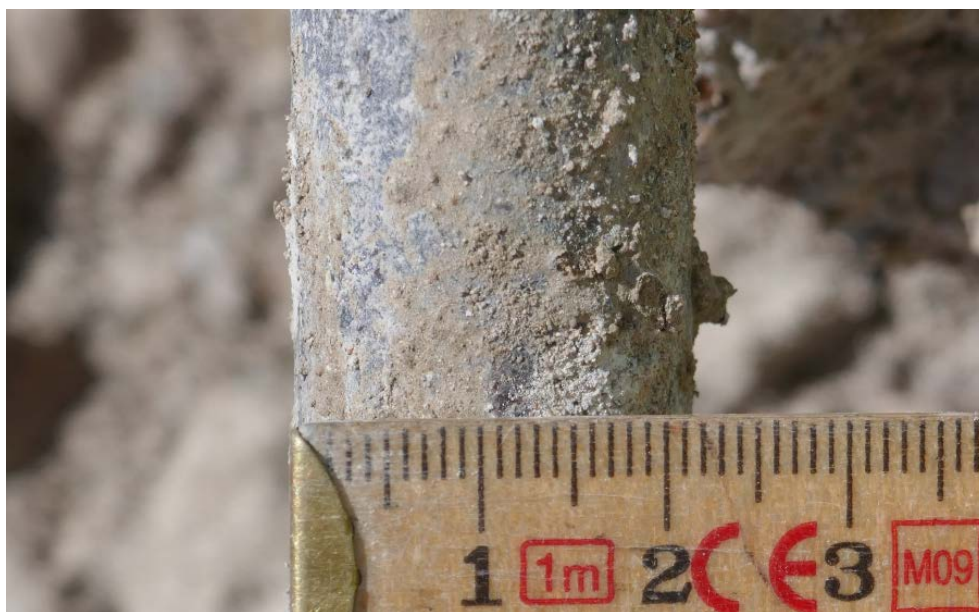
Figur 119. Armering av rundjärn med diameter cirka 20 mm. Inga spår av ytrost.
