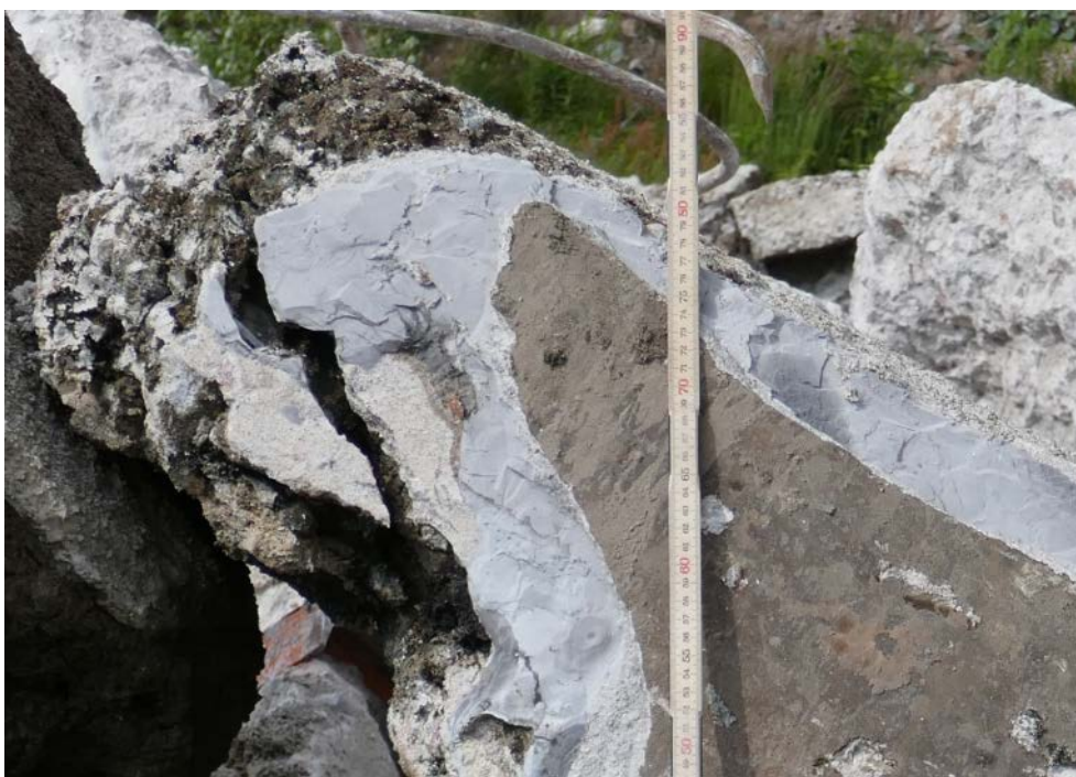
Figur 100. Friskt injekteringsbruk påträffades i ett skikt bakom putsskiktet. Det friska bruket antas härstamma från det nyligen utförda injekteringsarbetet. Betongstyckets läge i dammen framgår av Figur 98.
