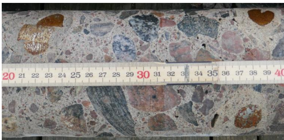
Figur 58. Närbild på betong mellan 1 och 2 m djup i pelare 12. Meterstock som referens.
