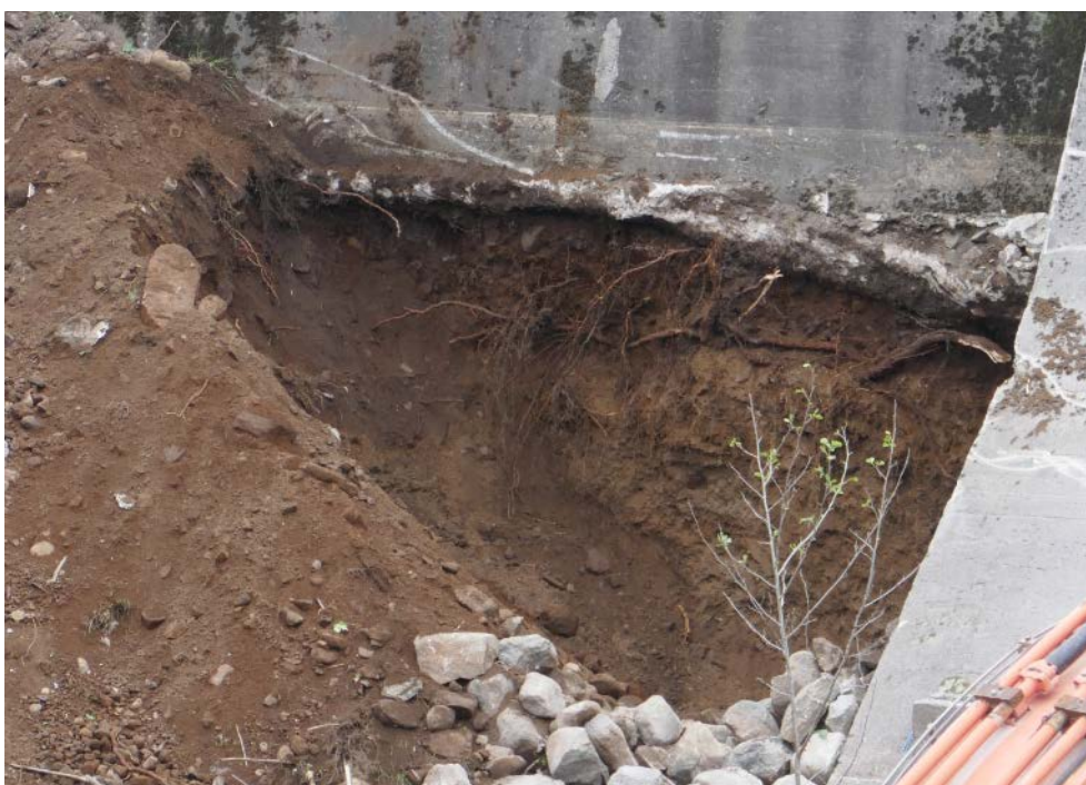
Figur 97. Efter vingmurens friläggning noterades det att rötter från växtlighet hade letat sig in under den.
