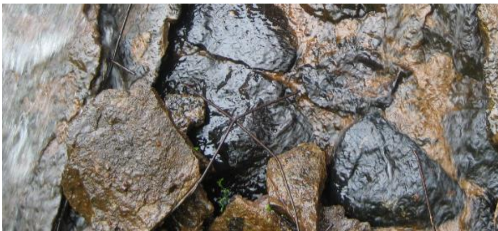
Figur 29. Närbild av skada där ursprunglig stenbeklädning hade täckts med ett armeringsförstärkt lagningsbruk.
