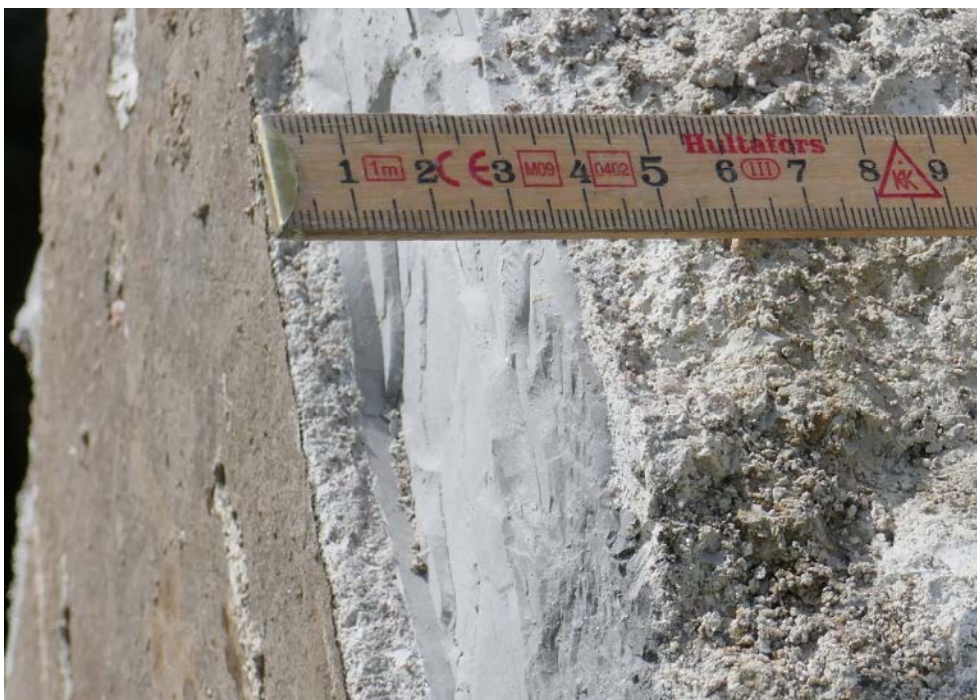
Figur 101. Det nyligen injekterade bruket hade fyllt ut ett utrymme bakom ett äldre lager cementbruk med det tidigare nämnda putsskiktet ytterst. Notera den sandiga brottytan som meterstocken ligger på.
