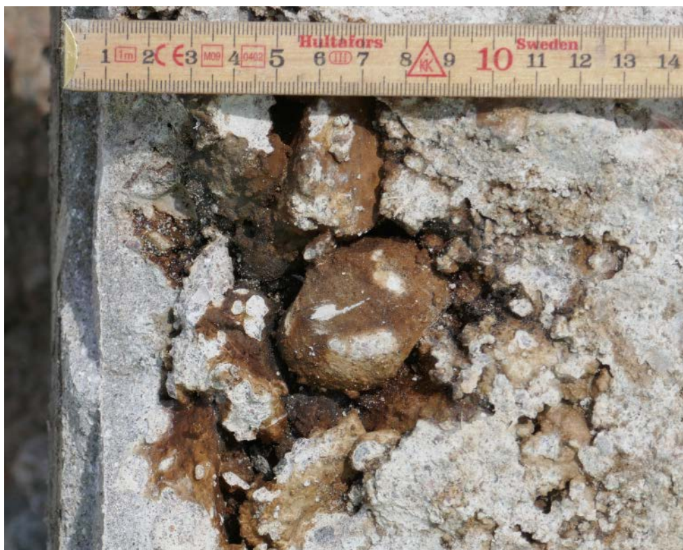
Figur 103. Långt gången urlakning av den ursprungliga betongen bakom det äldre cementbruket.
