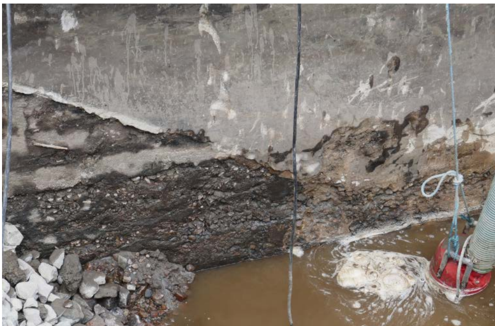
Figur 83. Uppströms utskov 5 saknades putsskiktet i ett område som karaktäriserades av att betongens grova ballast hade frilagts. Konturen på området tyder på att området kan ha utgjort anslutning för en fångdamm.
