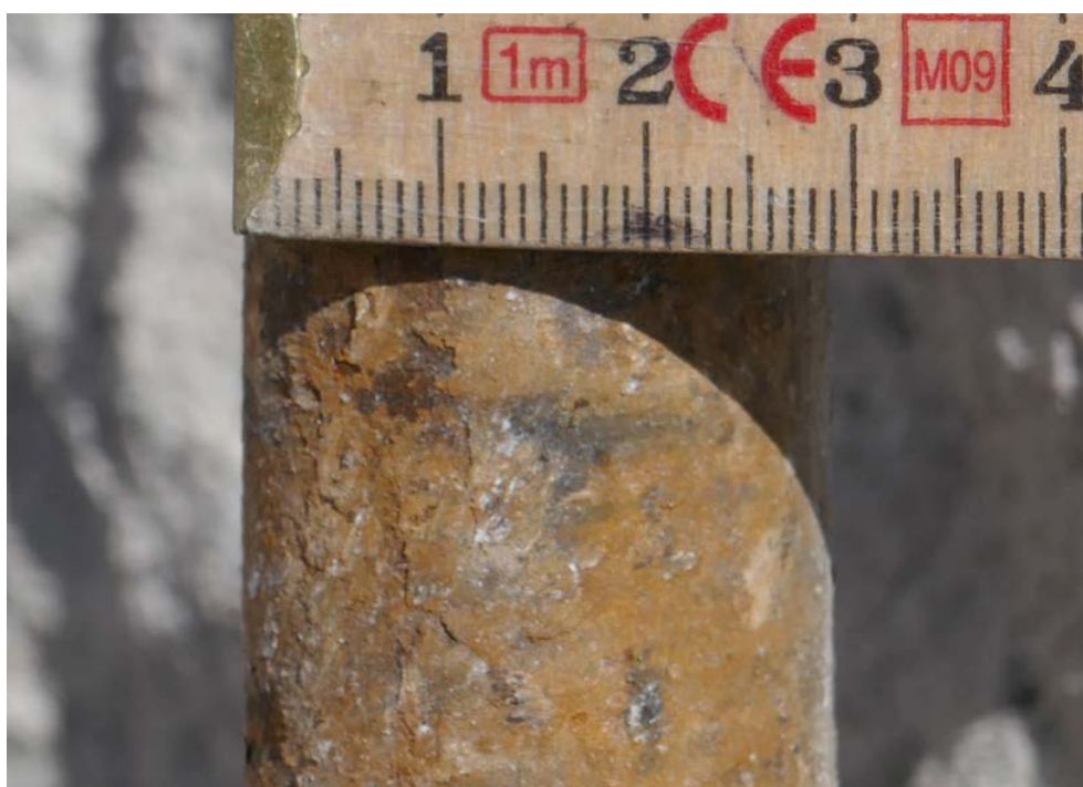
Figur 120. Armering av rundjärn med diameter cirka 30 mm. Notera förekomst av ytrost på järnet.
