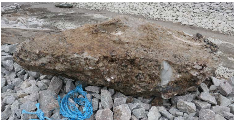
Figur 76. Tillvarataget betongstycke med injekteringsbruk i borrhål US från pelare 12. Till höger i fotografiet syns bruket (ljusgrått). Betongstycket satt strax ovanför respektive uppströms om borrhål US i Figur 108.
