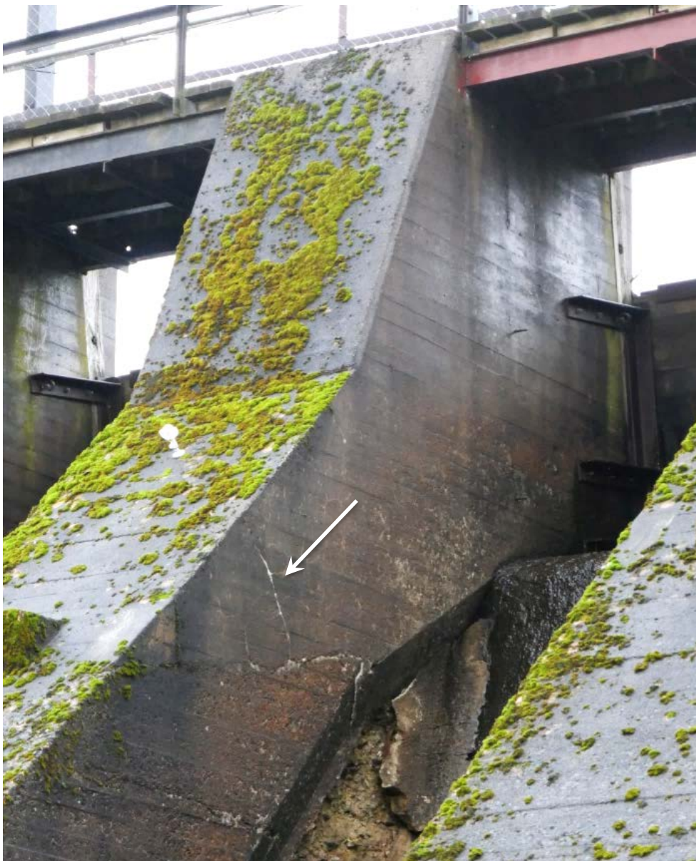
Figur 47. Pelare 10. Mossa i riklig mängd hade fått fäste på pelarens nedströmssida. Påväxten av mossor var betydligt mer sparsam på pelarens sidor. Tidigare nämnd gjutskarv respektive spricka (pil) syns på pelaren.
