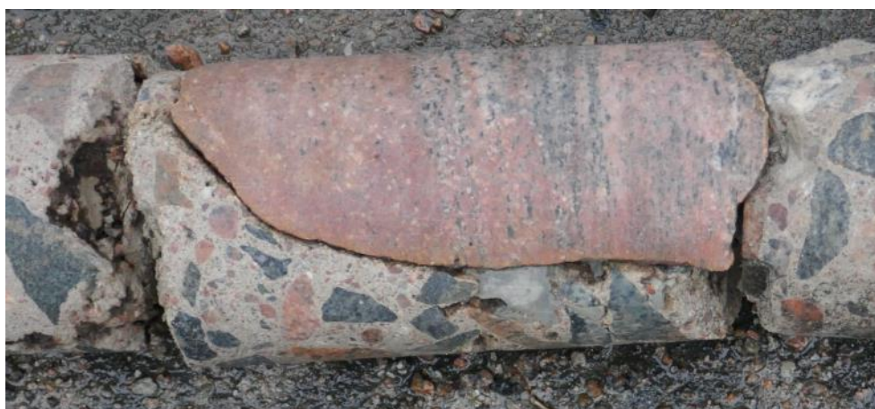
Figur 62. Närbild på sparsten i pelare 12. Notera injekteringsbruk och bruna missfärgningar vid stenen.
