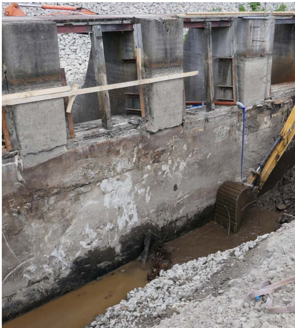
Figur 82. Horisontella sprickor noterades i putsskiktet på dammens uppströmssida. Den grävsta sprickan ligger ungefär 3 m nedanför stödpelarnas krön. I fotografiet syns stödpelare 10 längst till vänster.
