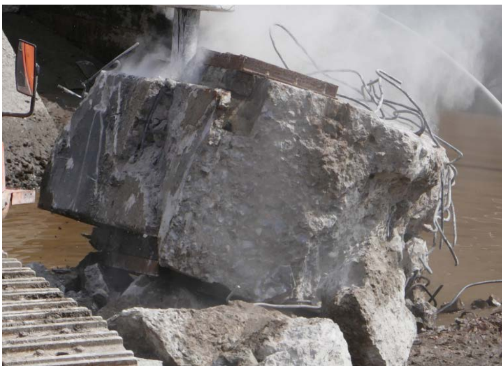
Figur 89. Pelare 11. Brottytan på undersidan av pelartoppen. Inga utstickande armeringsjärn noterades.
