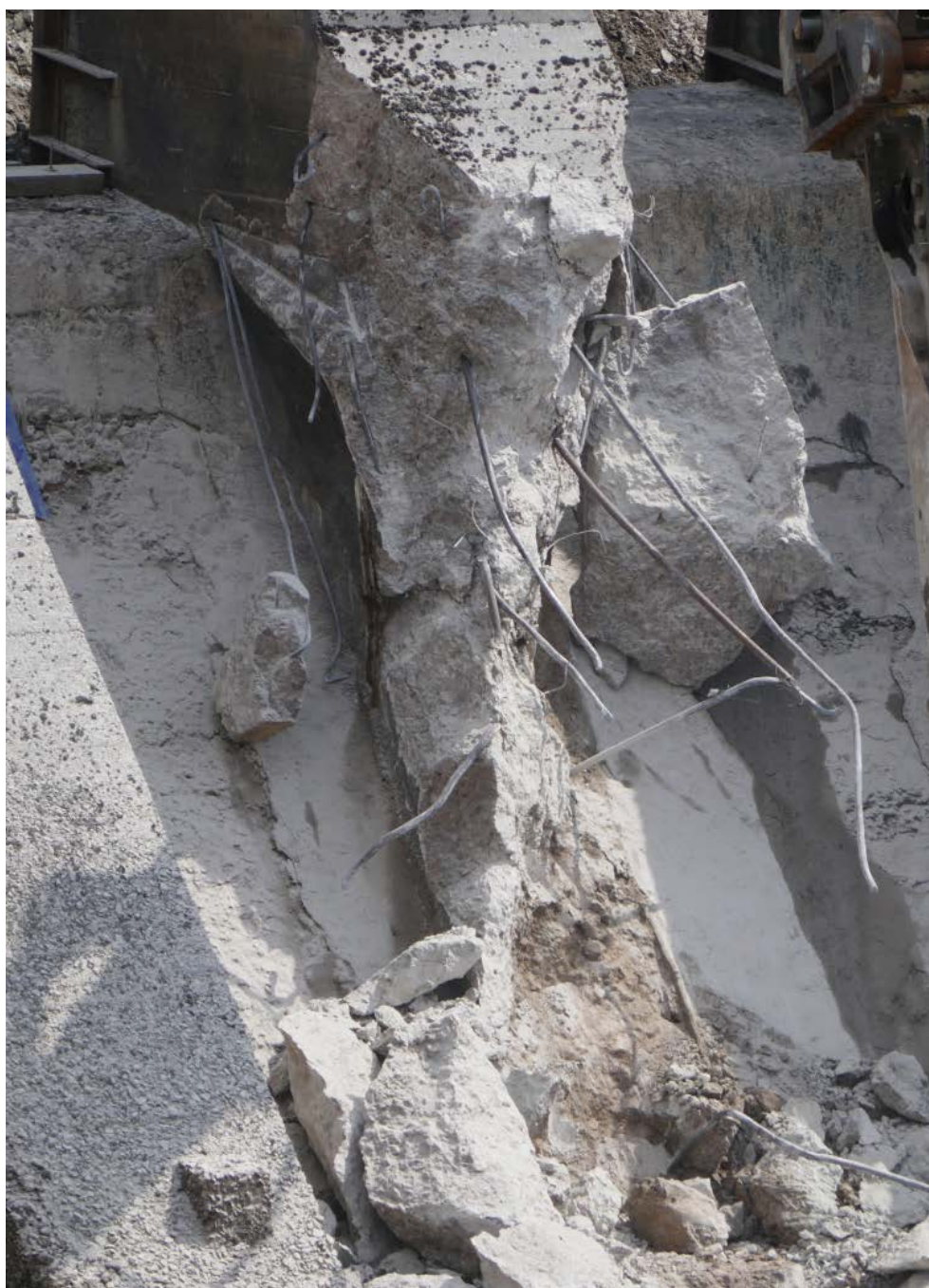
Figur 85. Pelare 11. Den ursprungliga betongen uppvisade en brunaktig kulör när den bilades fram.
