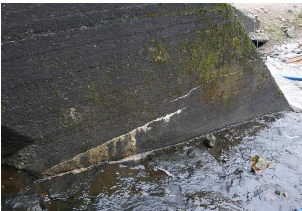
Figur 39. Pelare 8. Horisontell spricka (med vit- och brunfärgade kalkutfällningar) i pelarens nedre del.
