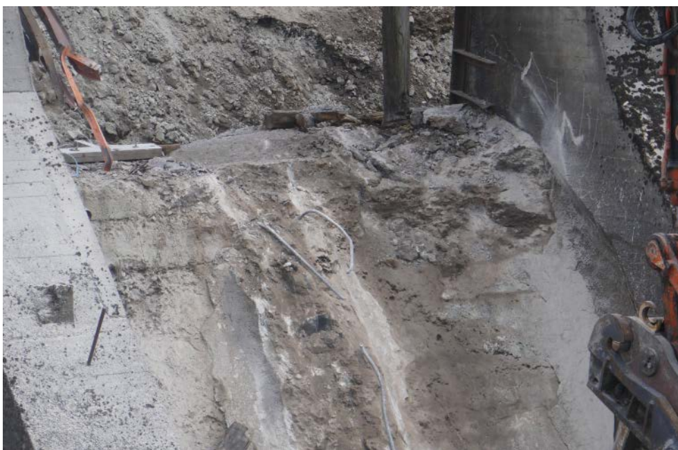
Figur 88. Pelare 11. Brottytan efter att pelartoppen hade välts ned.
