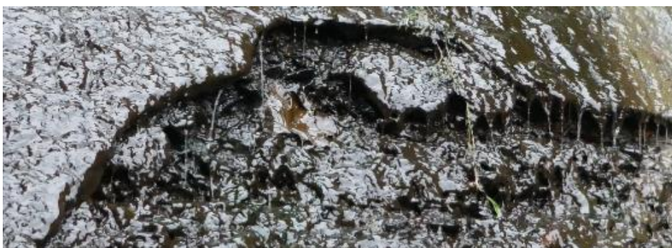
Figur 31. Närbild av skada i lagningsbruket där underliggande betong frilagts. Ytan är täckt av biologisk påväxt.
