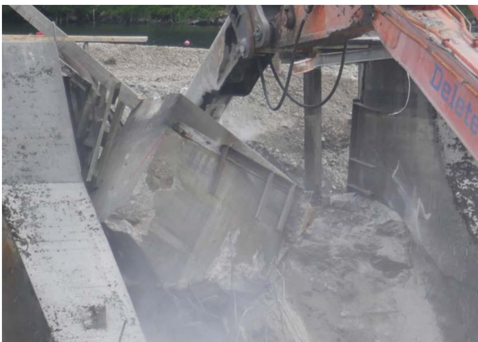
Figur 87. Pelare 11. Pelartoppen revs ned i ett stycke efter att den hade belastats från vänster sida.
