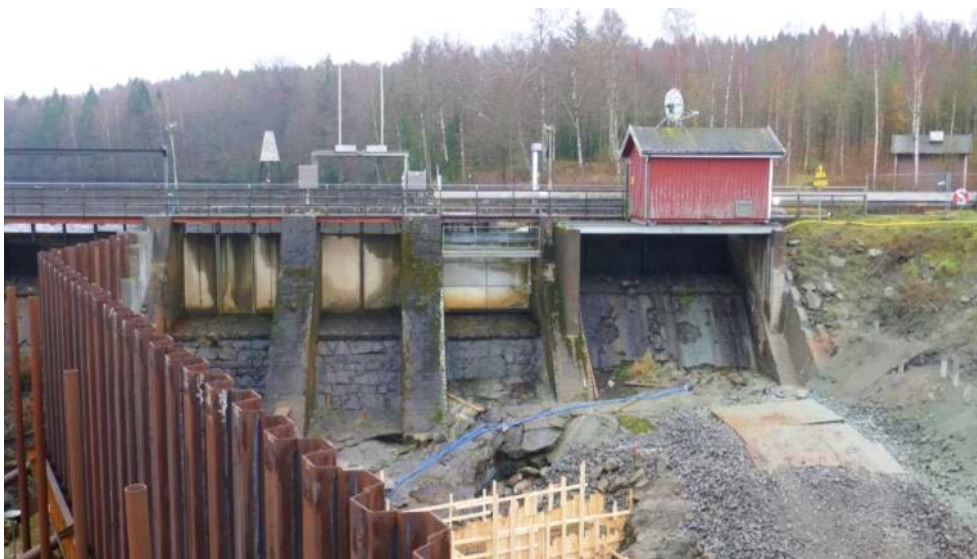
Figur 23. Nedströmssidan av den vänstra delen av utskovsdammen i november 2018. I fotografiet syns utskov 1–4 respektive stödpelare 1–5. Numrering från vänster till höger i vattnets flödesriktning. Träsklar och skibord i utskov 2–4 är klädda med sten. Utrivning av denna del av dammen planeras till vintern 2019/2020.
