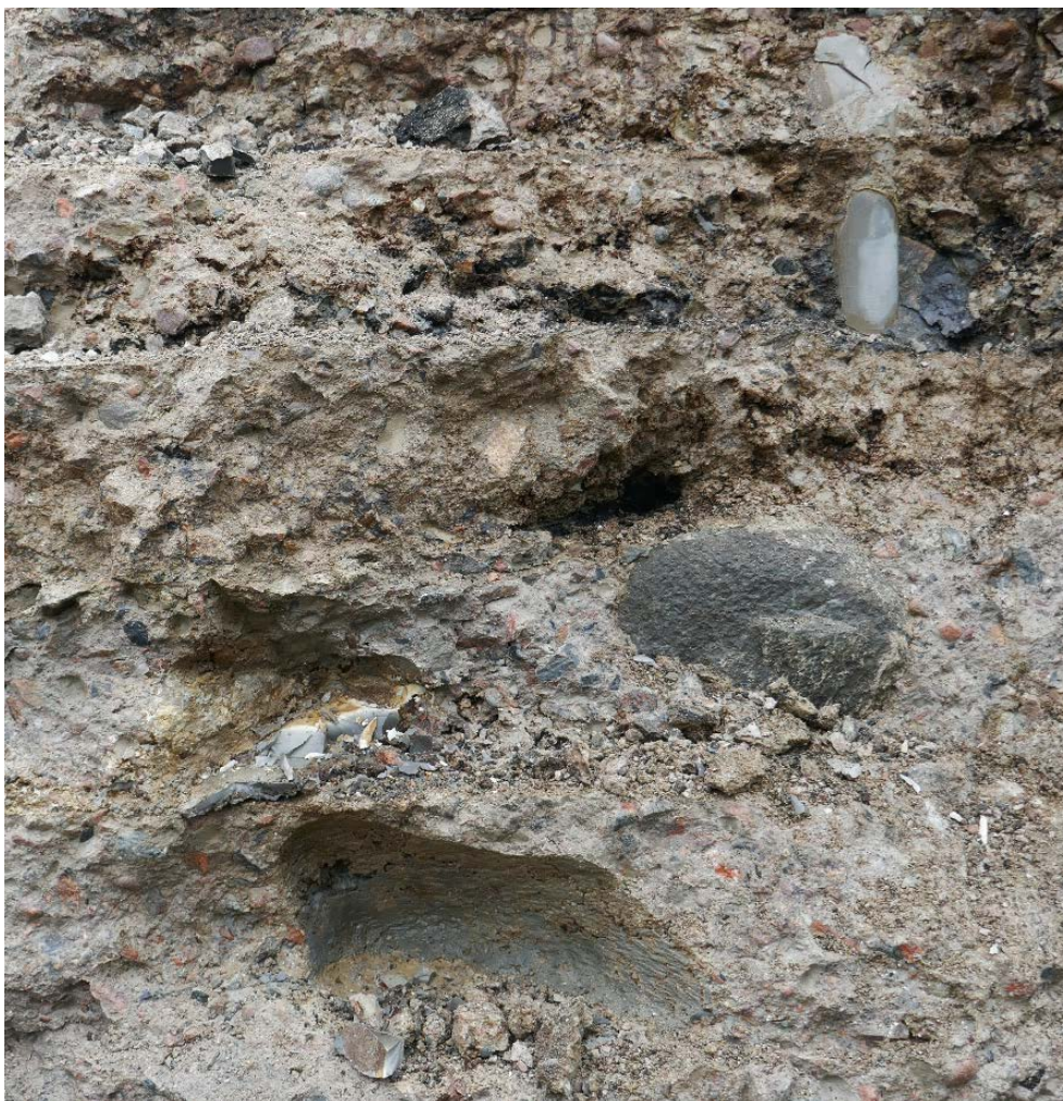
Figur 110. Pelare 12. I närheten av det med injekteringsbruk igenfyllda borrhål US (uppe till höger) noterades bruk i gränsskiktet runt en bortfallen sparsten (nedtill i mitten). Bruk påträffades också i en utfylld större hålighet strax ovanför sparstenen. Horisontellt avstånd till borrhål US uppskattades till cirka 60–70 cm.
