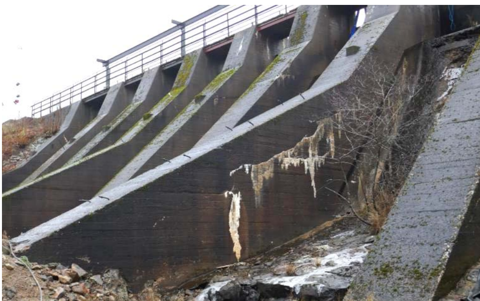
Figur 40. Pelare 7. Sned spricka med vita kalkutfällningar i den övre delen av pelarens förlängning nedströms. Notera att motsvarande spricka och kalkutfällningar saknas i bakomvarande pelare 10 (lika utformning).
