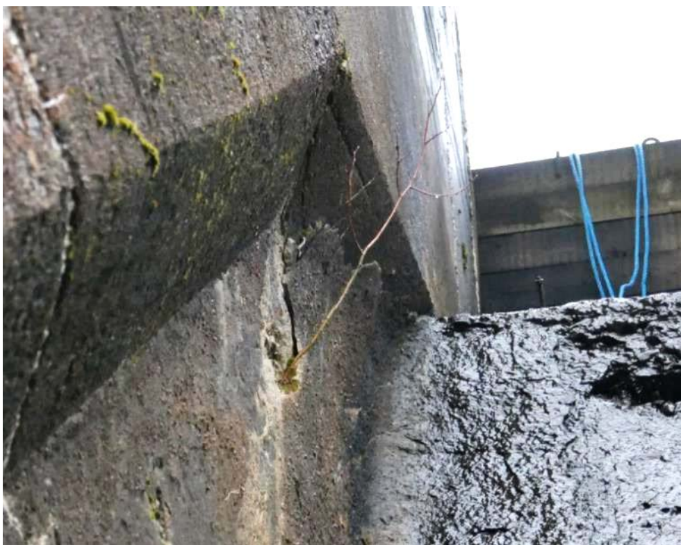
Figur 49. Pelare 7 – vänster sida. Växande sly i ett område där nedbrytning av betong och bruk pågått en tid.
