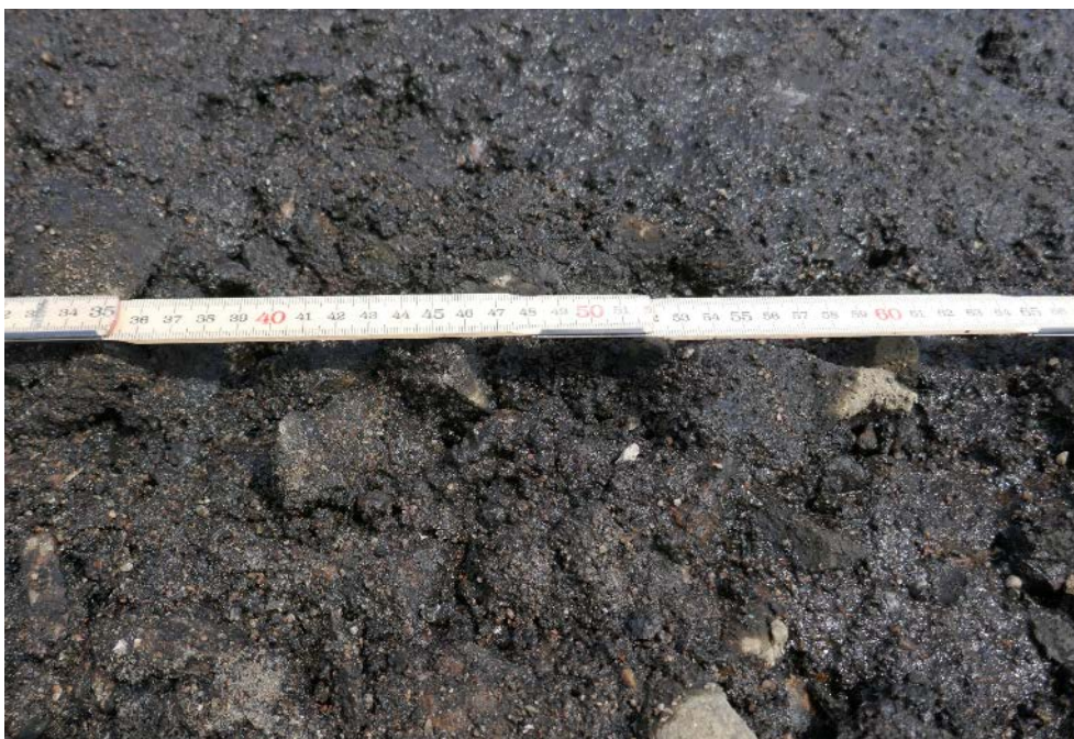
Figur 106. Ställvis var betongen i brottytorna nästan svartfärgad. Ytorna var dock fortfarande sandiga.
