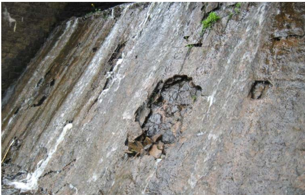
Figur 28. Det brant lutande skibordet i utskov 1. Skador med olika omfattning har uppkommit i lagningen.
