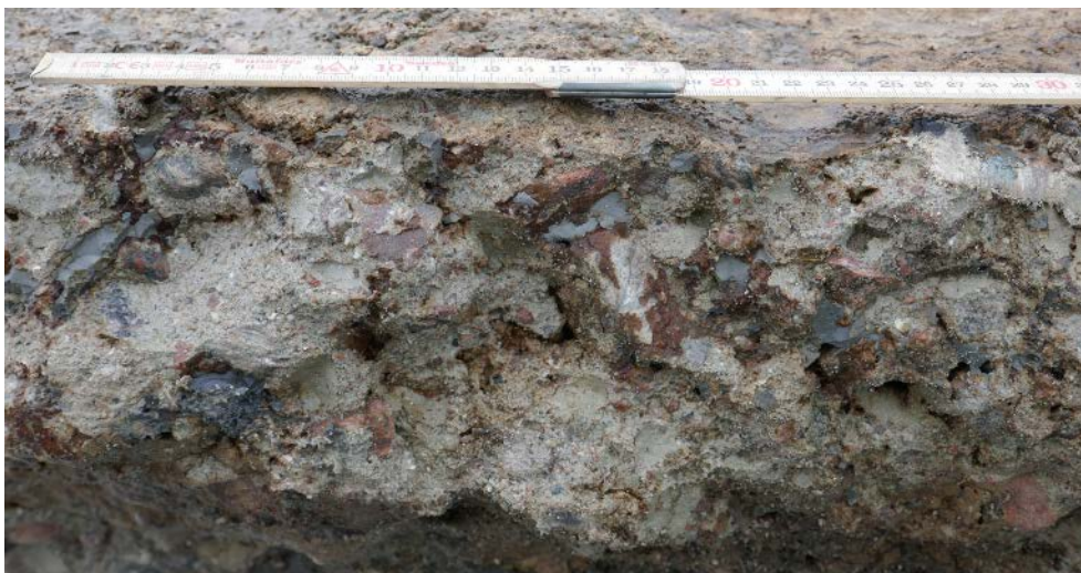
Figur 77. Närbild av betongstycket i Figur 76. Injekteringsbruk har fyllt ut mindre håligheter i betongen.
