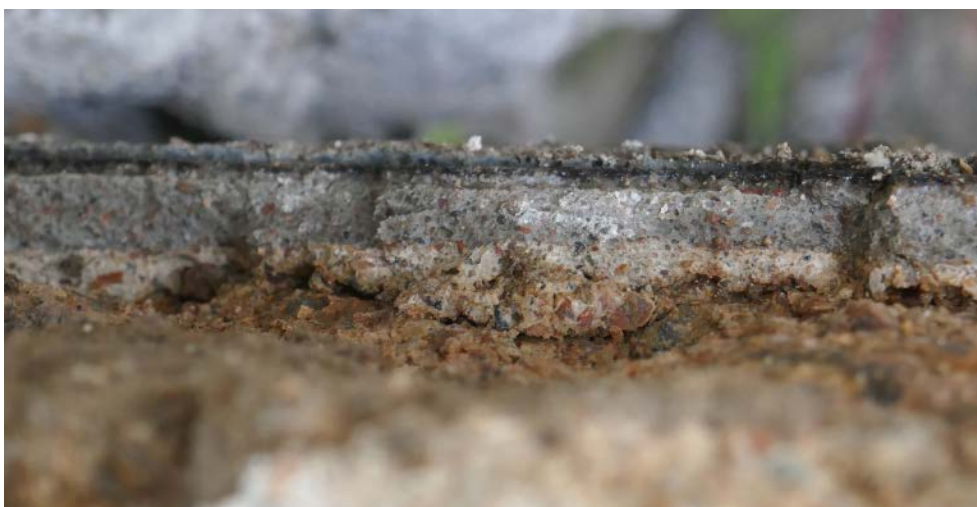
Figur 102. Längsgående spricka i betongen bakom det äldre cementbruket. Sprickan är parallell med bruket. Den bruna missfärgningen indikerar att sprickan har varit vattenförande och att betongen därmed urlakats.
