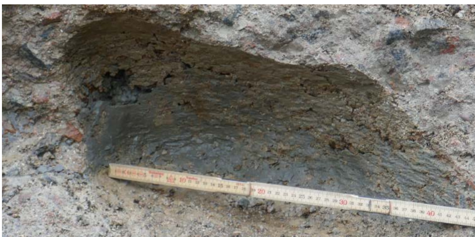
Figur 111. Pelare 12. Närbild på injekteringsbruk runt den bortfallna sparstenen. Notera mindre och större kvarvarande håligheter i omgivande betong. Notera bruk också i betongen till vänster om sparstenen.
