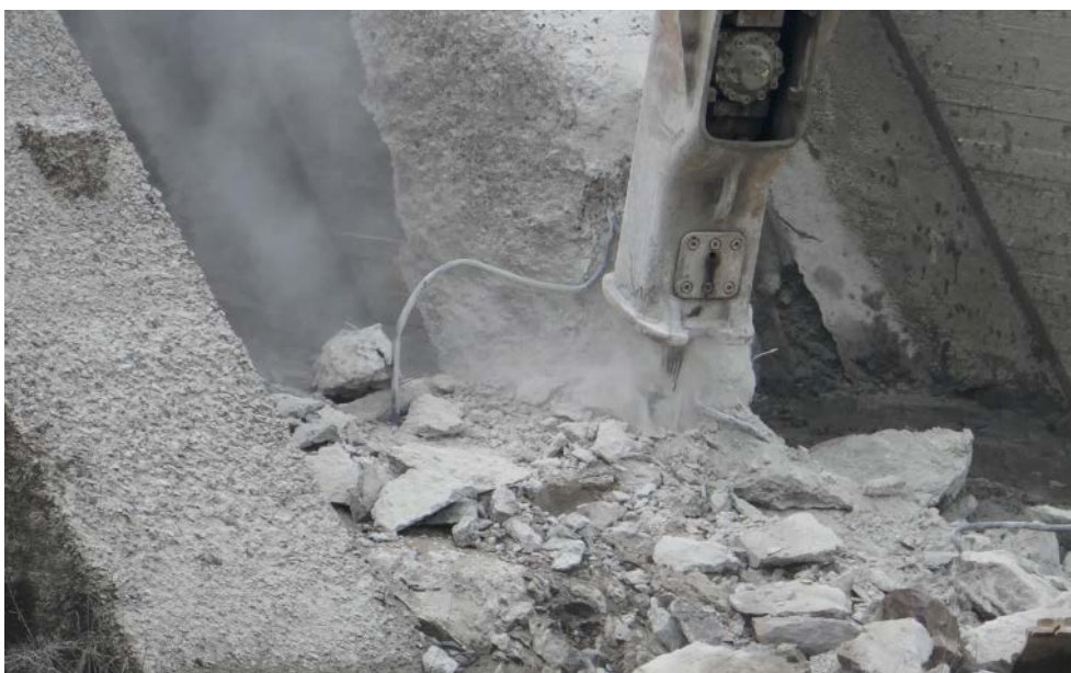
Figur 84. Pelare 11. När betongen spräcktes bekräftades det att 1940-talets pågjutning hade armerats.
