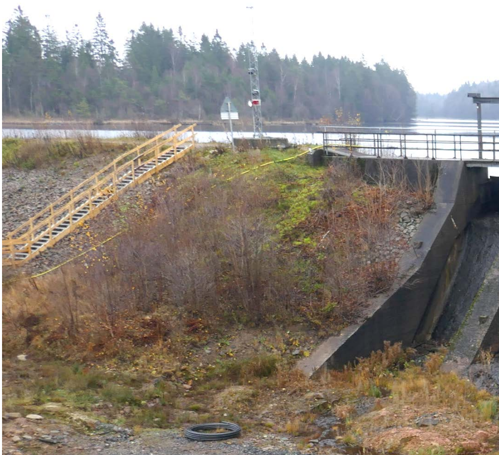
Figur 50. Större buskar växte intill pelare 13 vid anslutningen mellan utskovsdamm och jordfyllningsdamm.
