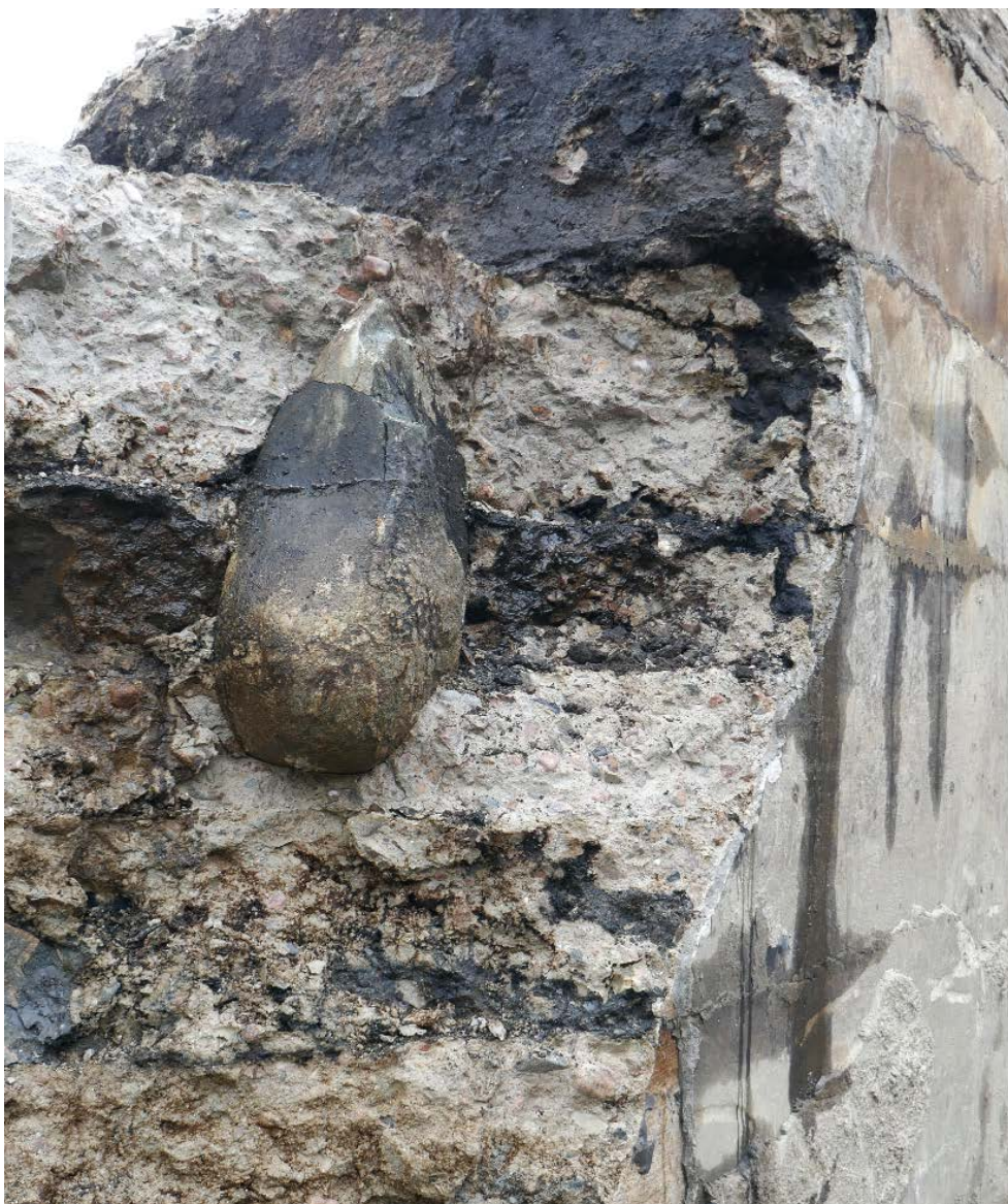
Figur 107. Horisontella stråk med mörkbruna, nästintill svarta, missfärgningar kan ses inuti i dammen på nivåer som sammanfaller med de horisontella sprickorna i putsskiktet. En vertikal yta syns högst upp i fotografiet och motsvarar troligtvis gjutfogen mellan den ursprungliga betongen och höjningen av utskovströskeln.
