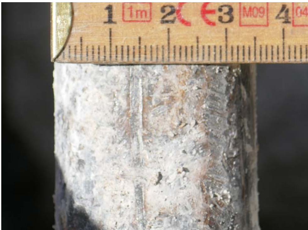
Figur 121. Armering av rundjärn med diameter cirka 35 mm. Minimala spår av ytrost.
