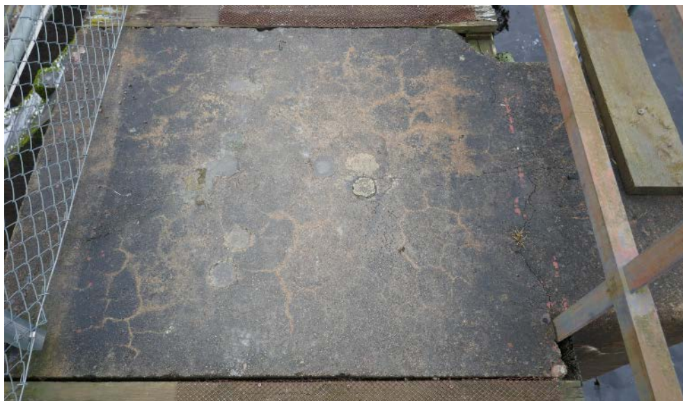
Figur 45. Pelare 9. Krackelerad yta på pelarens krön. Igenfyllda äldre Injekteringshål kan också noteras.
