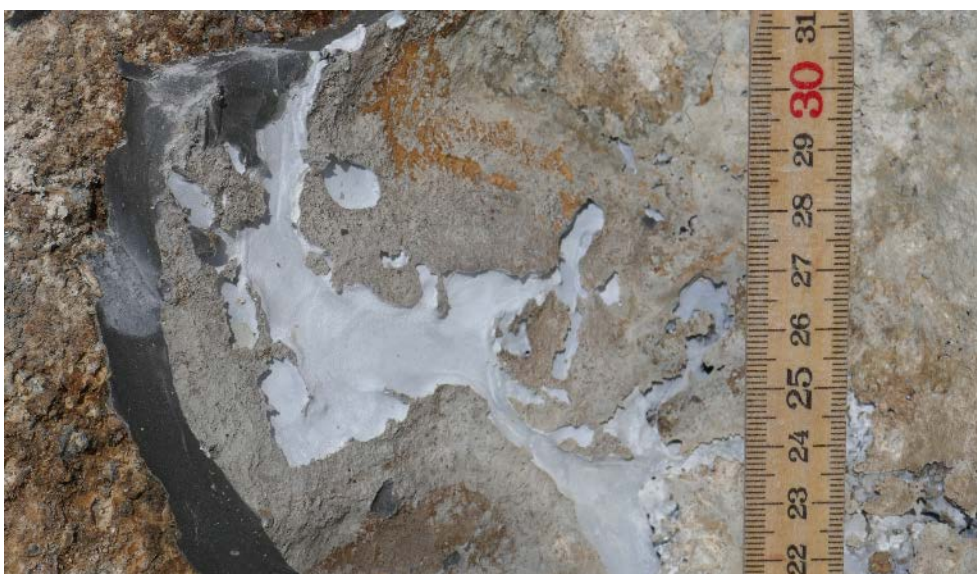
Figur 113. Närbild på område med friskt injekteringsbruk. Vad som kan ses är att total utfyllnad av gränsskiktet ej har erhållits. Befintligt vatten i utrymmet har ej pressats ut eller så har vattenseparation uppstått i bruket.
