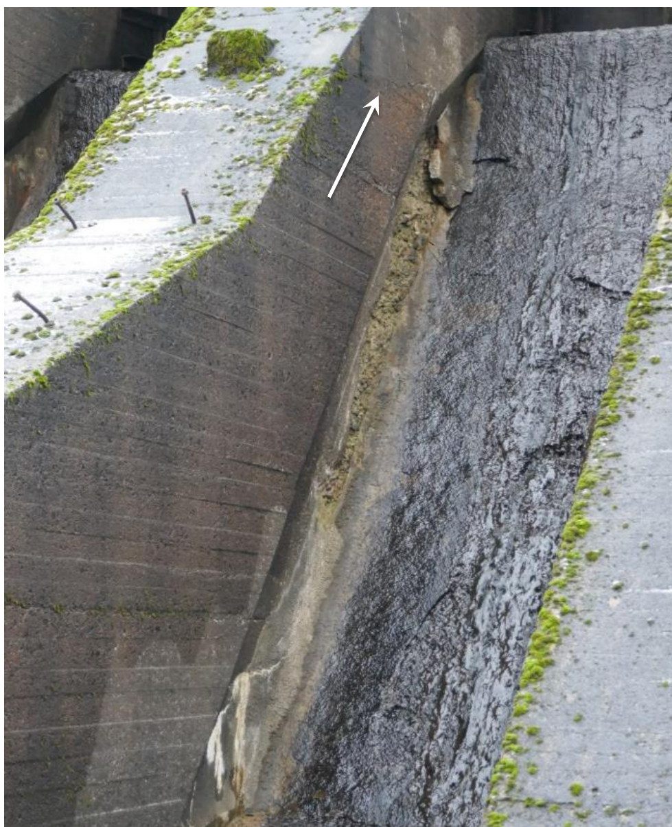
Figur 34. I fotografiet syns den pågående nedbrytningsprocessen av bruk och betong längs den långsmala ursparingen i sidan av pelare 10. Gjutfogen från 1940-talets höjning syns också (vit pil).
