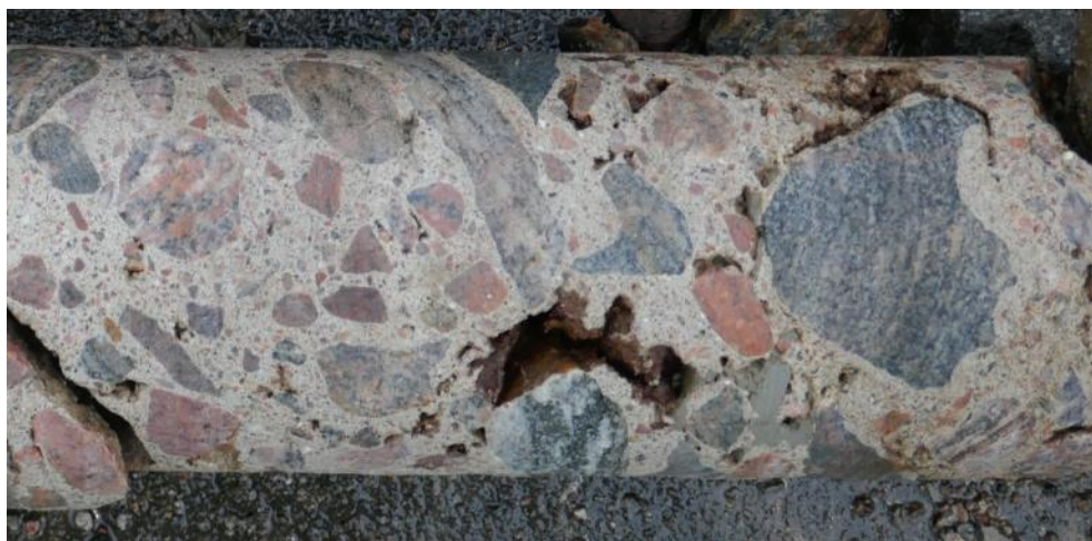
Figur 60. Närbild på betong mellan 3 och 5 m djup i pelare 12. Notera håligheterna med bruna missfärgningar.
