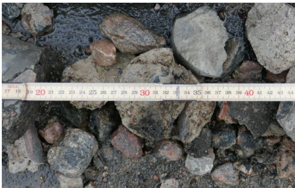
Figur 61. Närbild på betong av usel kvalitet mellan 3 och 5 m djup i pelare 12. Meterstock som referens.
