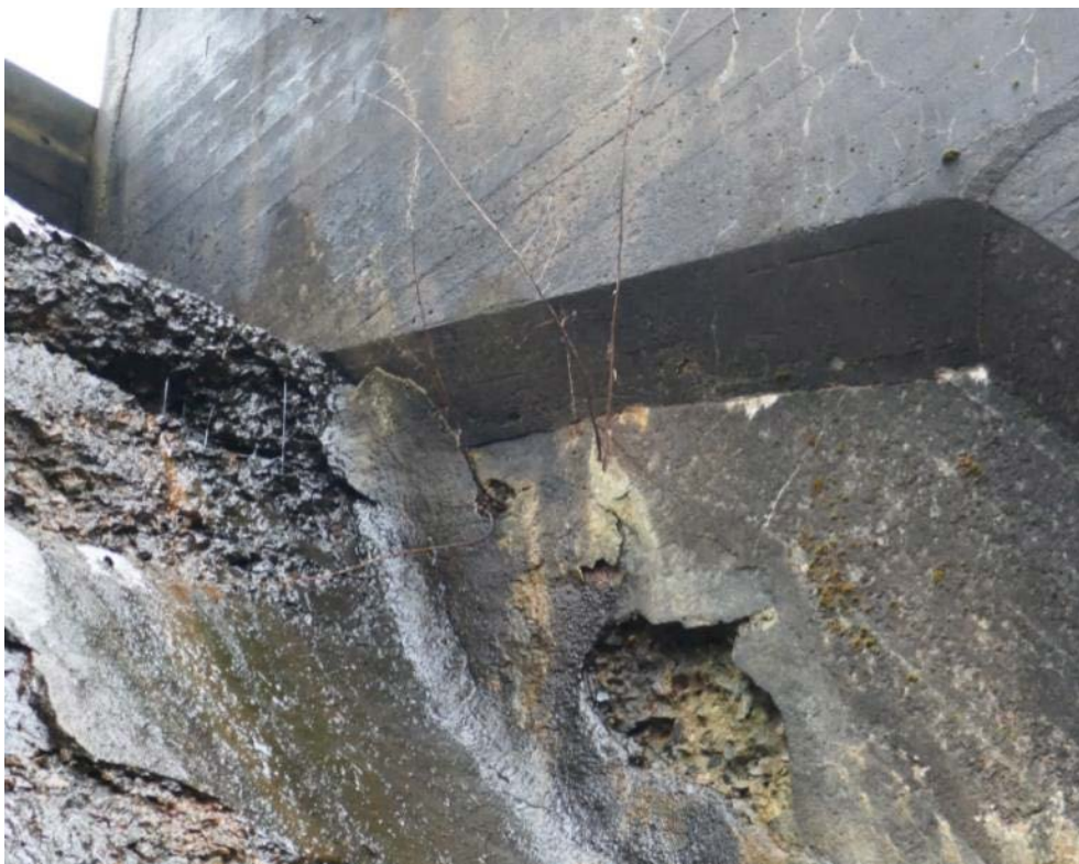
Figur 48. Pelare 6 – höger sida. Växande sly i ett område där nedbrytning av betong och bruk pågått en tid.
