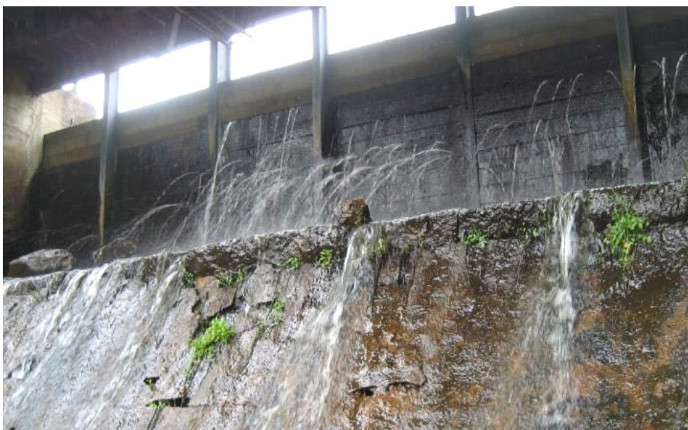
Figur 26. Läckage mellan luckornas sättar i utskov 1 leder till att vatten konstant rinner över skibordet. Både växtlighet och skador förekommer på skibordet. Fotografi från maj 2011.
