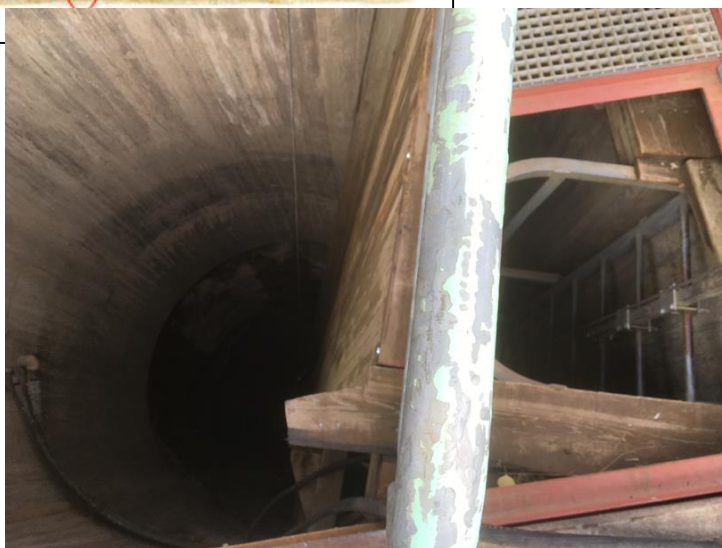
Ventilationsschakt ovanför G1 och G2
